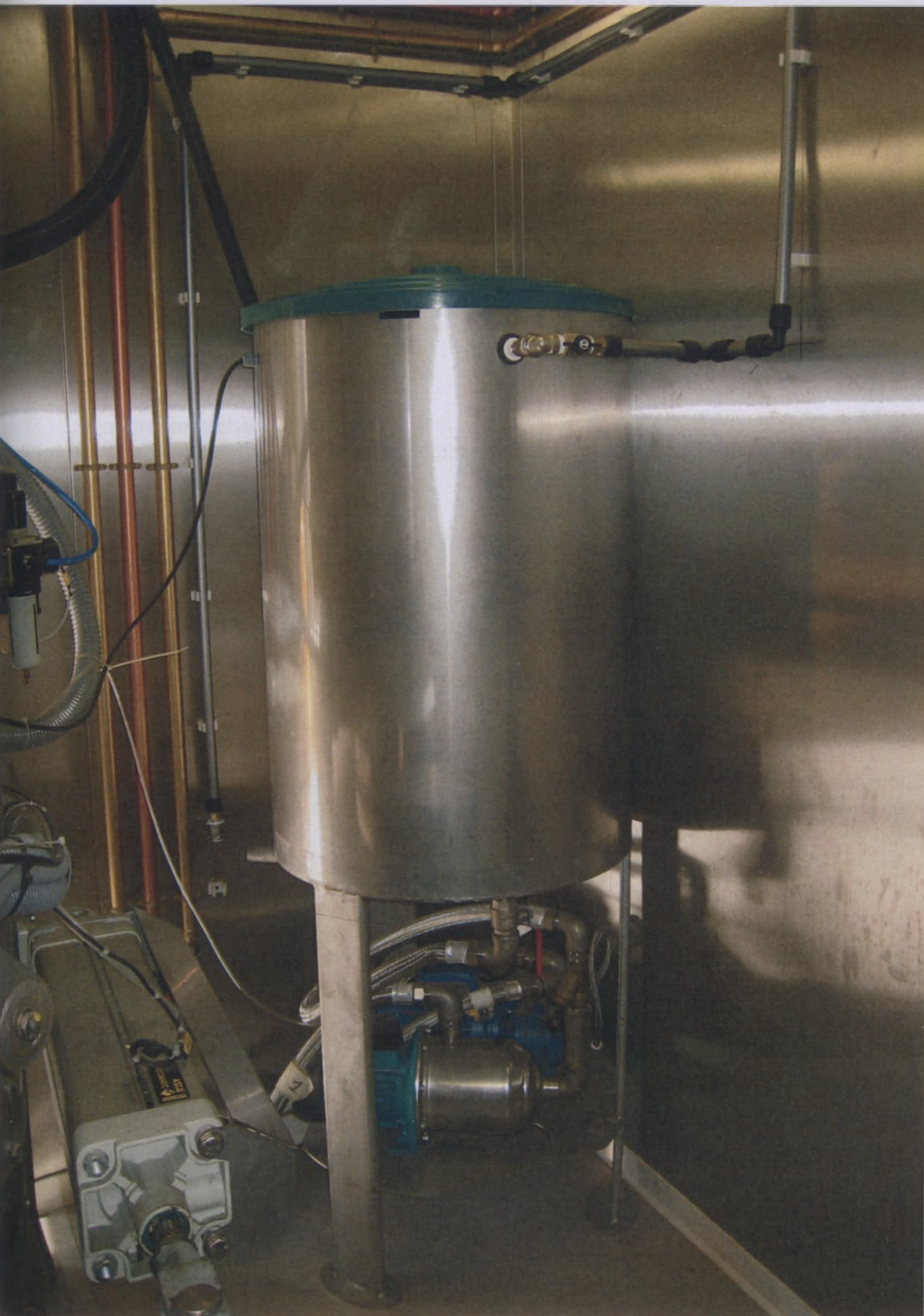
Бак для питающей воды с насосами. Фото 2.
