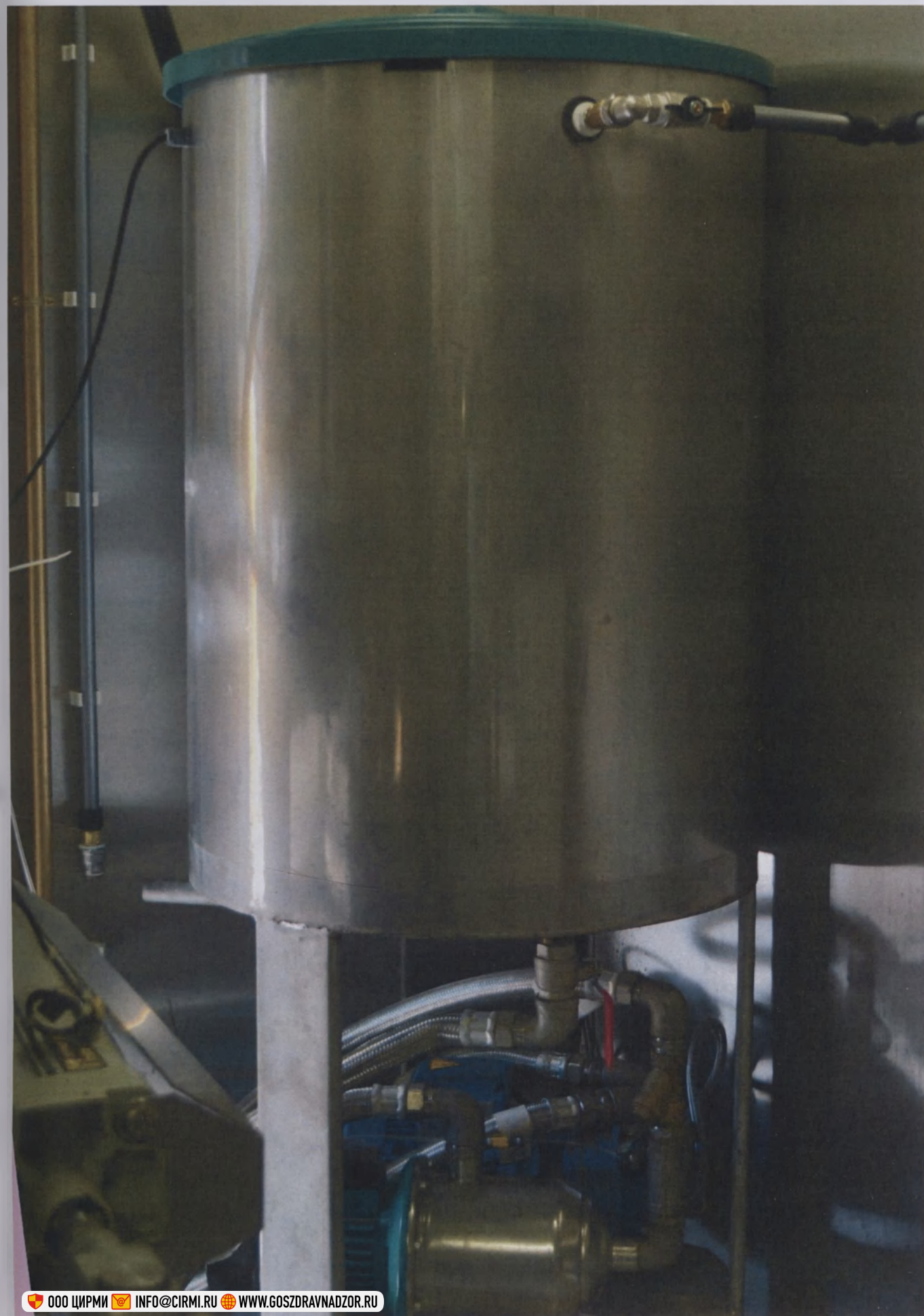
Бак для питающей воды с насосами. Фото 1.
