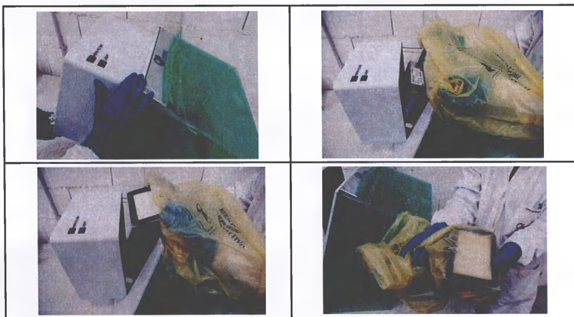
Рисунок 8.7 Замена блока фильтрации
