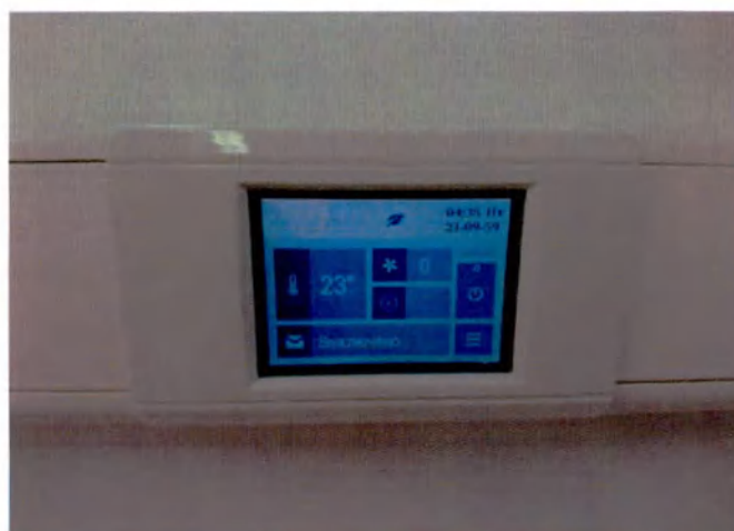
Рисунок 11.1. Пульт управления вентиляционной фильтрующей установкой.
