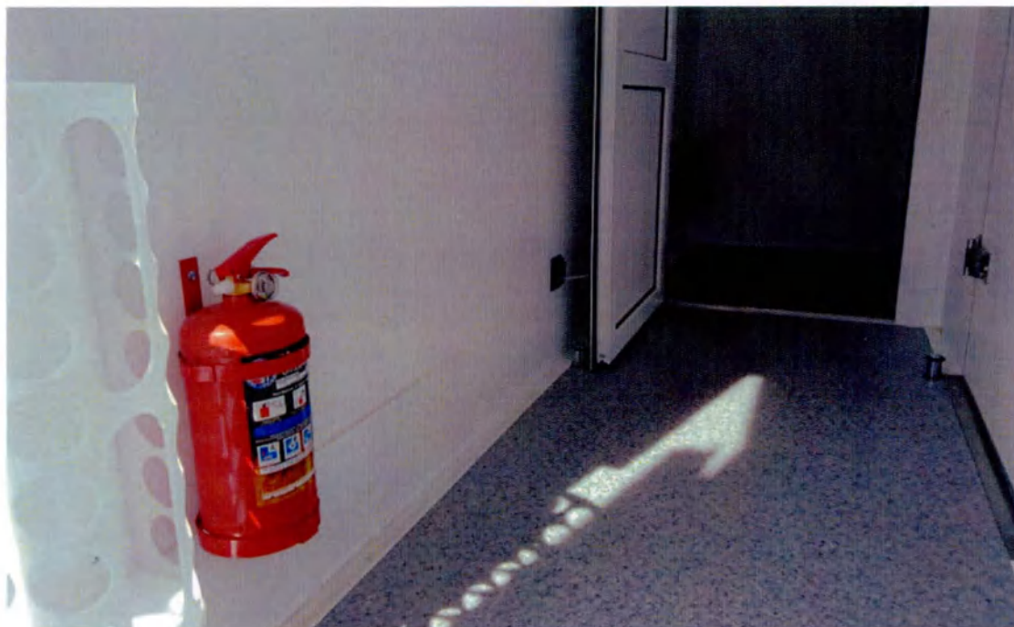
Рисунок 16. Огнетушители (внутри Комплекса).
