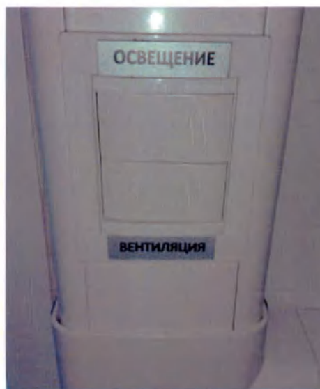
Рисунок 14. Включатель принудительной вытяжной вентиляции.
