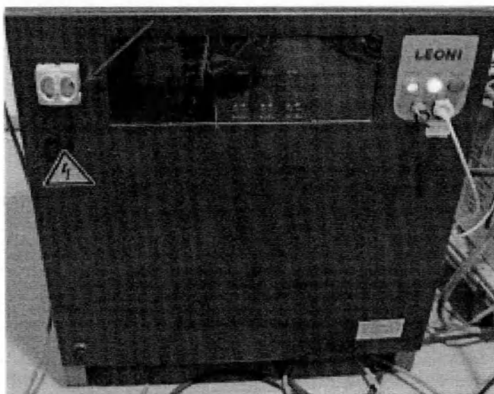
Рисунок 91. Выключатель питания на шкафу электрооборудования роботизированного манипулятора
