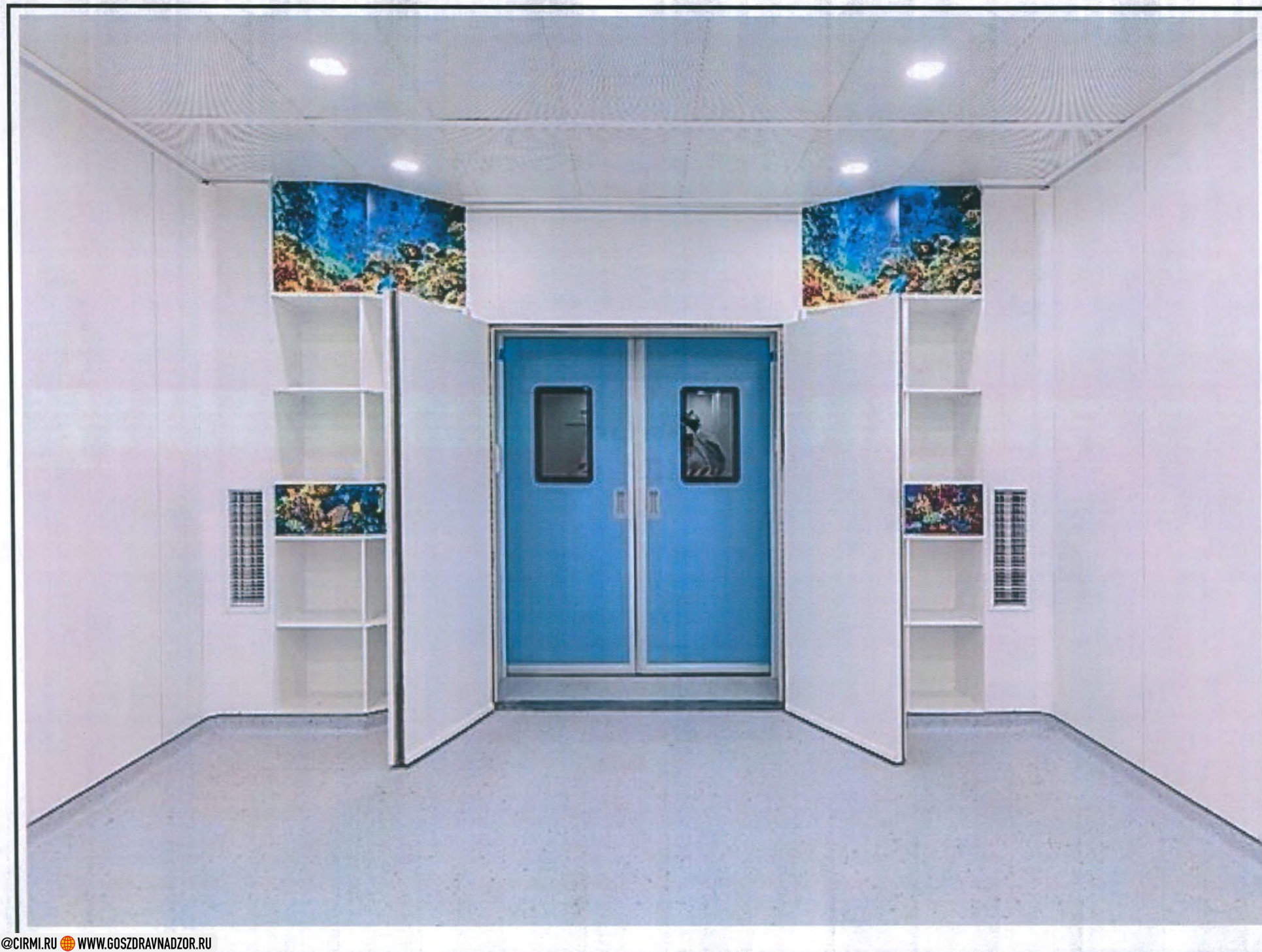
35. Устройство для защитного экранирования помещения (Клетка Фарадея).
