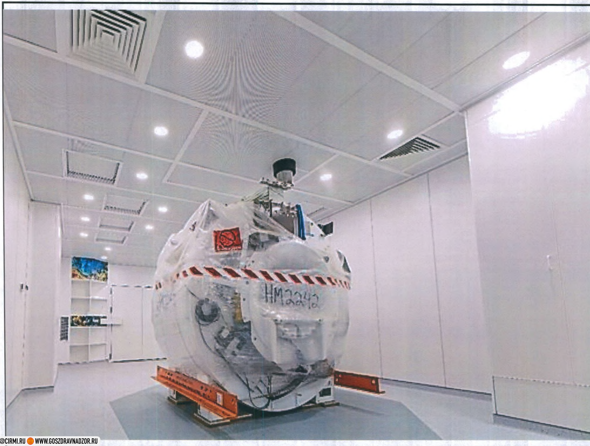
35. Устройство для защитного экранирования помещения (Клетка Фарадея).
