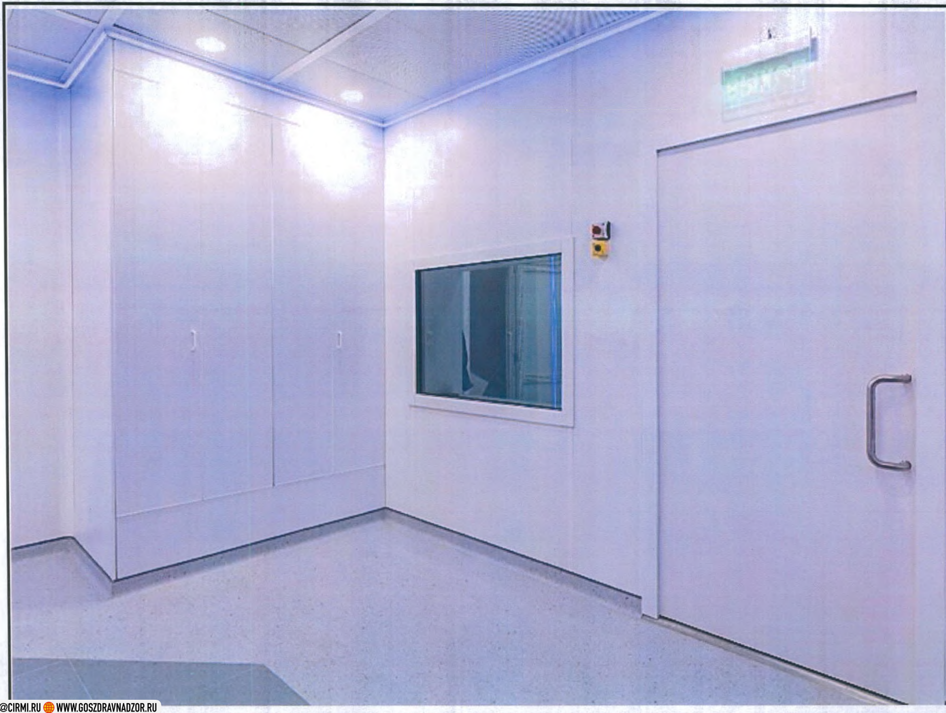
35. Устройство для защитного экранирования помещения (Клетка Фарадея).
