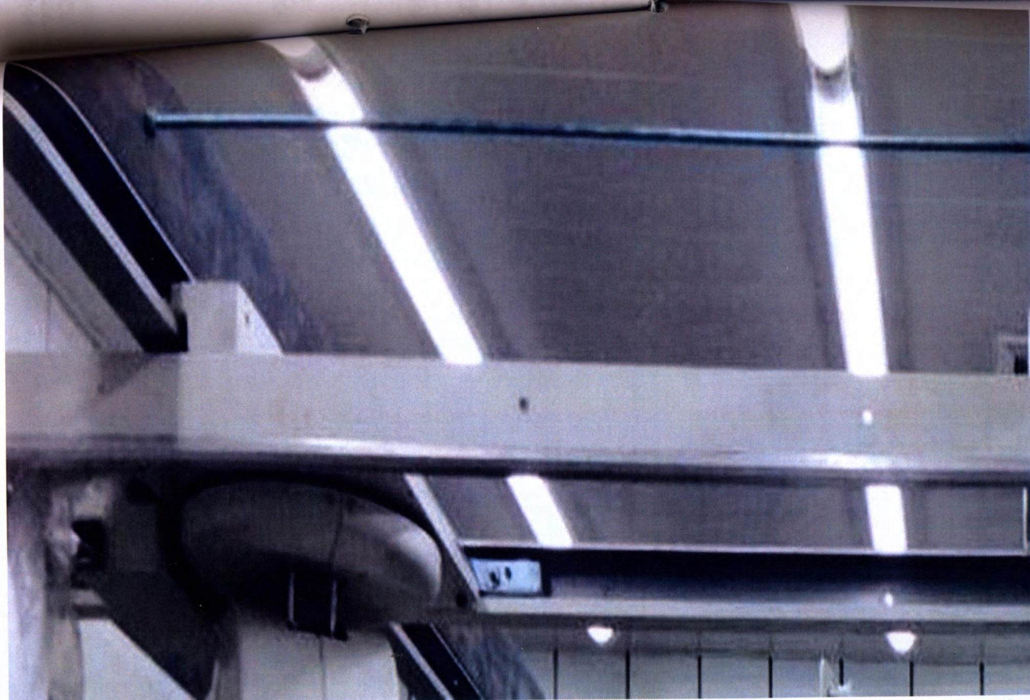
Рельсы для подвешного оборудования.
