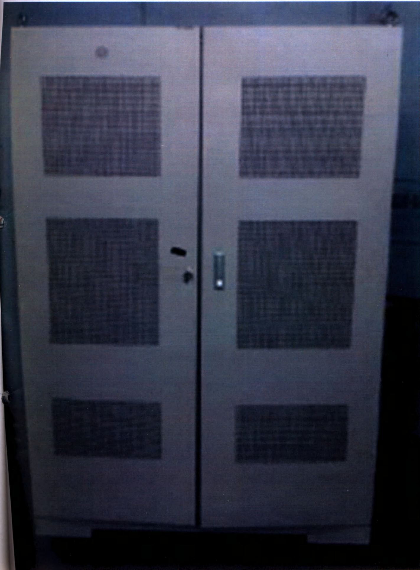
Шкаф управления системы.
