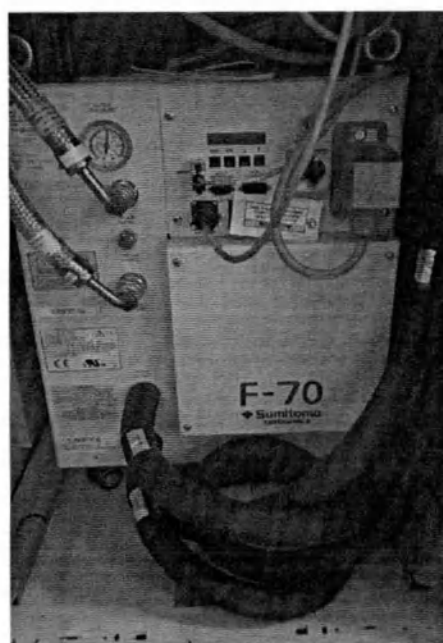
Низкотемпературный компрессор F-70.
