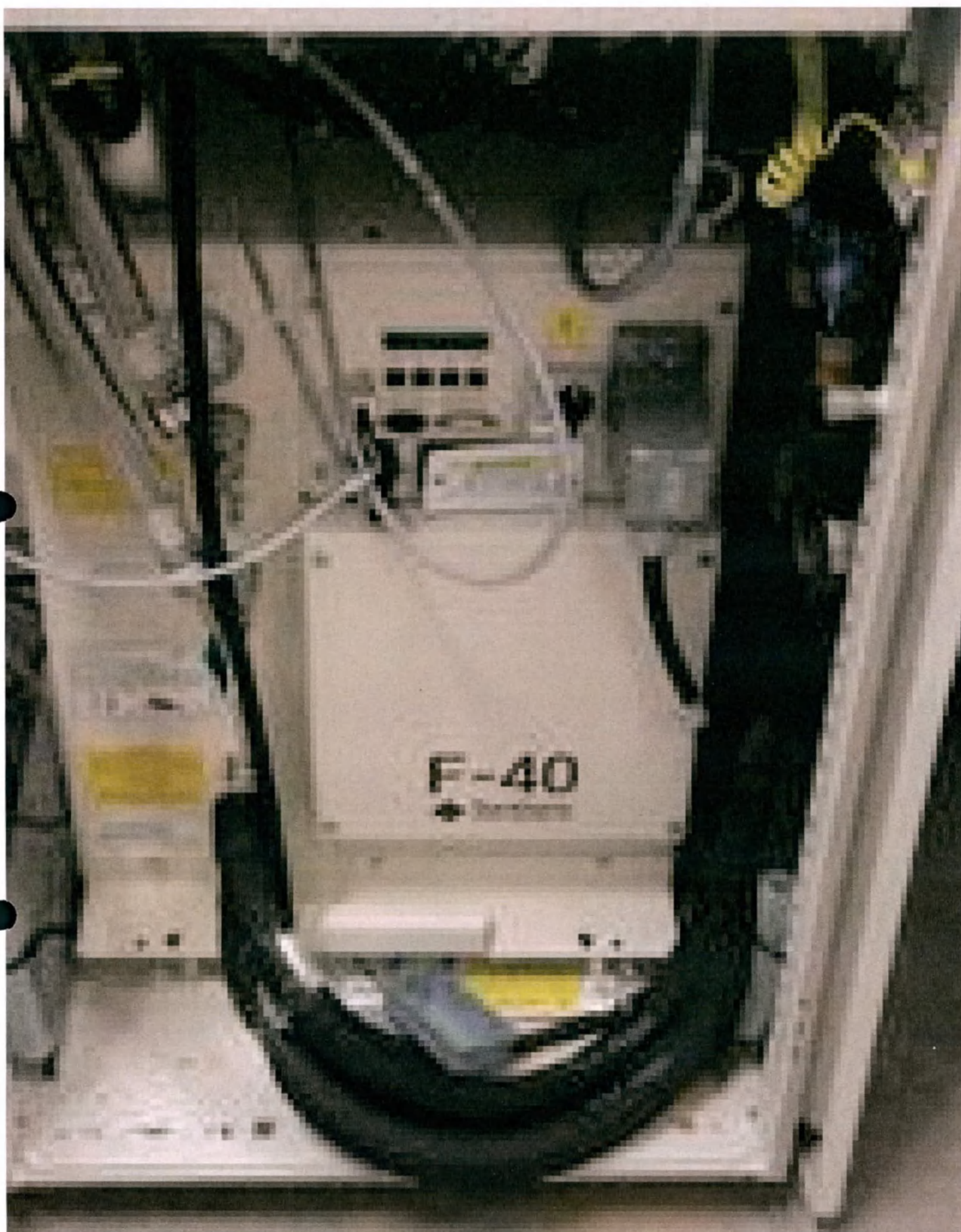
17.1. Низкотемпературный компрессор F-40.
