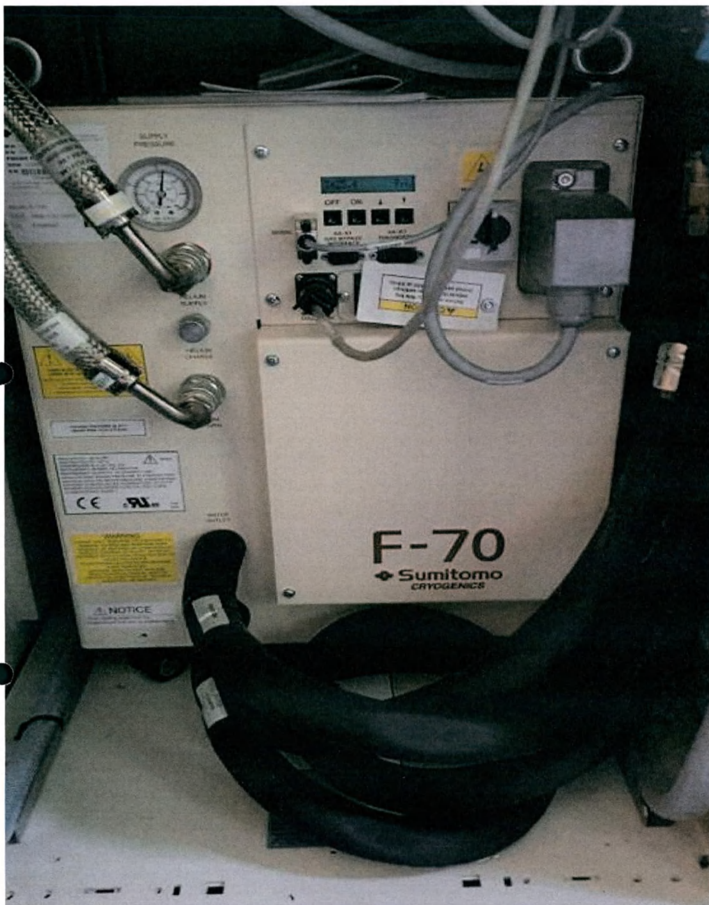
17.2. Низкотемпературный компрессор F-70.
