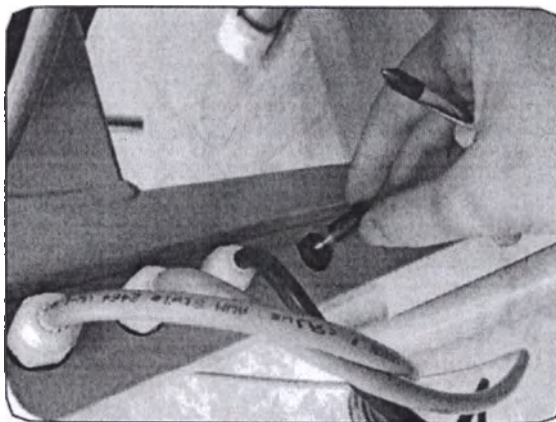
Рисунок 9.1 – Замена плавкого предохранителя
