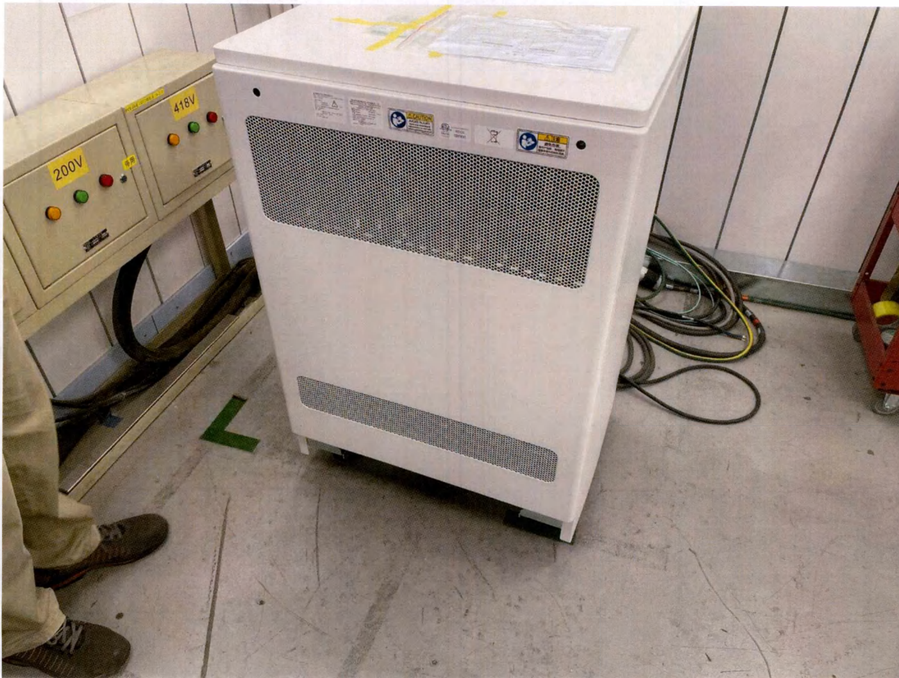
Рисунок 26 – Шкаф питания распределительный
