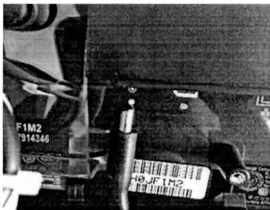
Рисунок 38. Подключение кабеля питания
