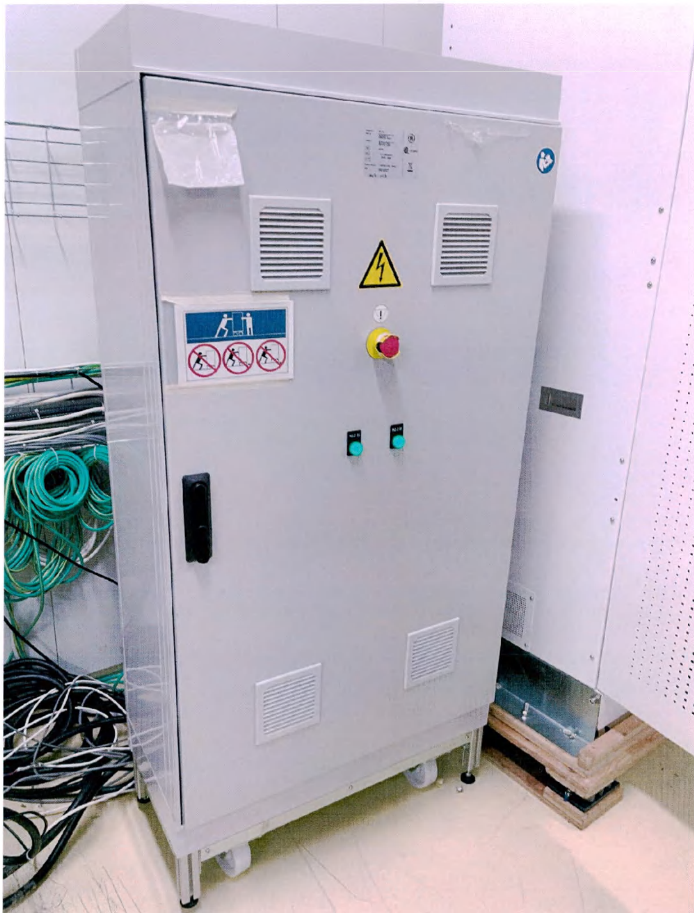
Рисунок 17. Распределительный щит для источника бесперебойного питания
