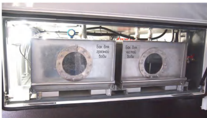
Рис. 50 ««ПКЯ 3» правая сторона ПМК – бак «чистой воды» и бак «грязной воды»»
