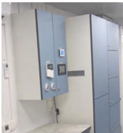
Рис. 44 «Шкаф с пультом управления вентиляцией»
