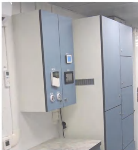
Рис. 52 «Шкафчик с вмонтированными датчиками уровня воды»
