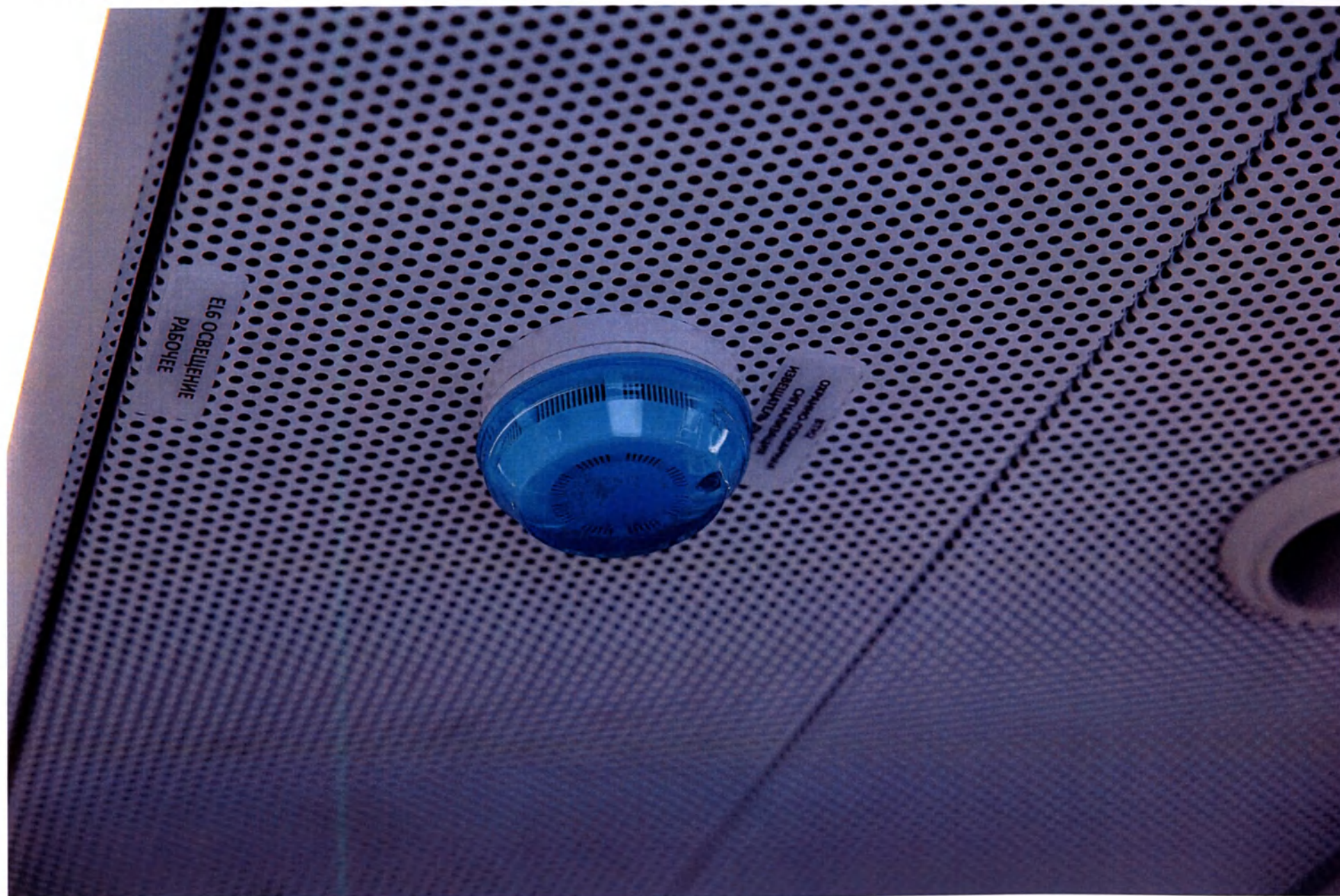
2.8. Кабинет физиотерапии 1. Извещатель пожарно-дымовой оптико-электронный ИП 212-45.
