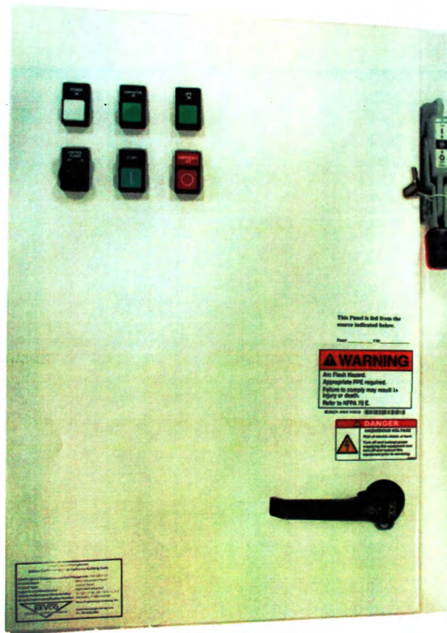
Рис. 65. Щит питания распределительный. (1 шт.).
