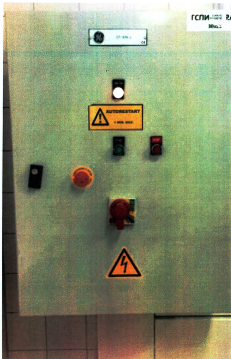
Рис. 67. Щит питания распределительный. (1 шт.).
