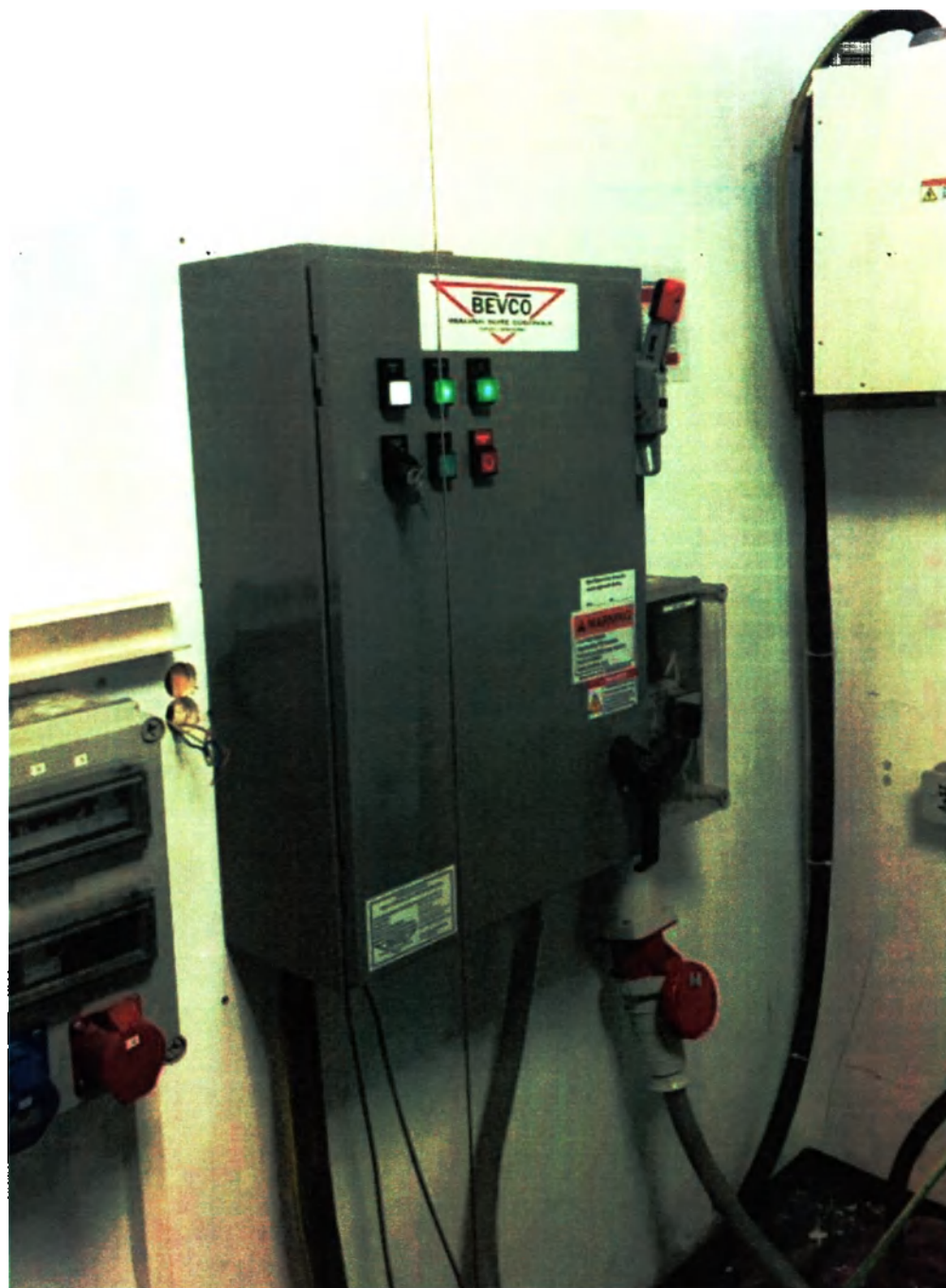
Рис. 68. Щит питания распределительный. (1 шт.).
