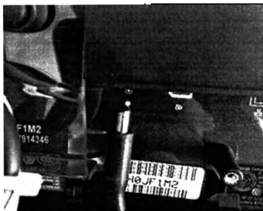
Рисунок 15. Подключение кабеля питания
