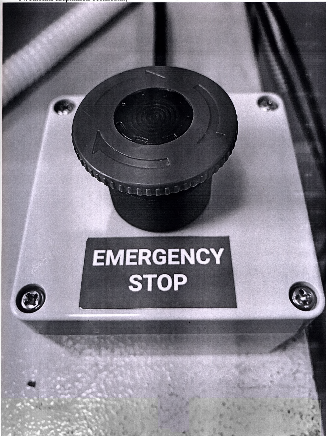
14. Кнопка аварийной остановки;
