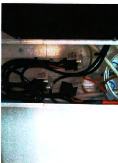
Плавкие предохранители в кабель-канале с маркировкой.
