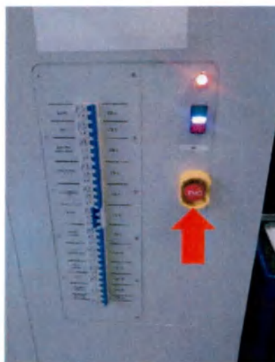
Кнопка аварийного отключения питания на распределительном щите питания
