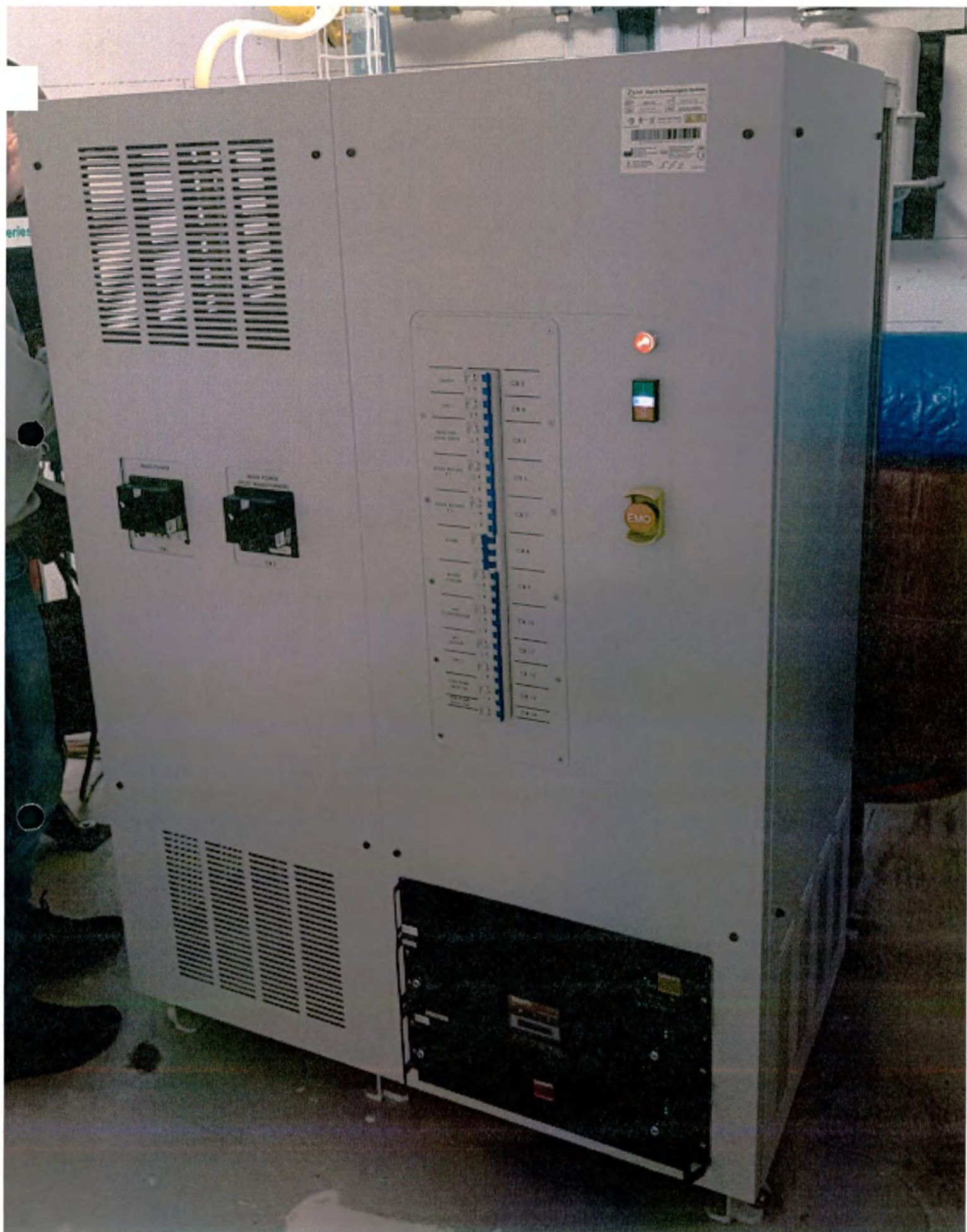
Силовой электрораспределительный шкаф
