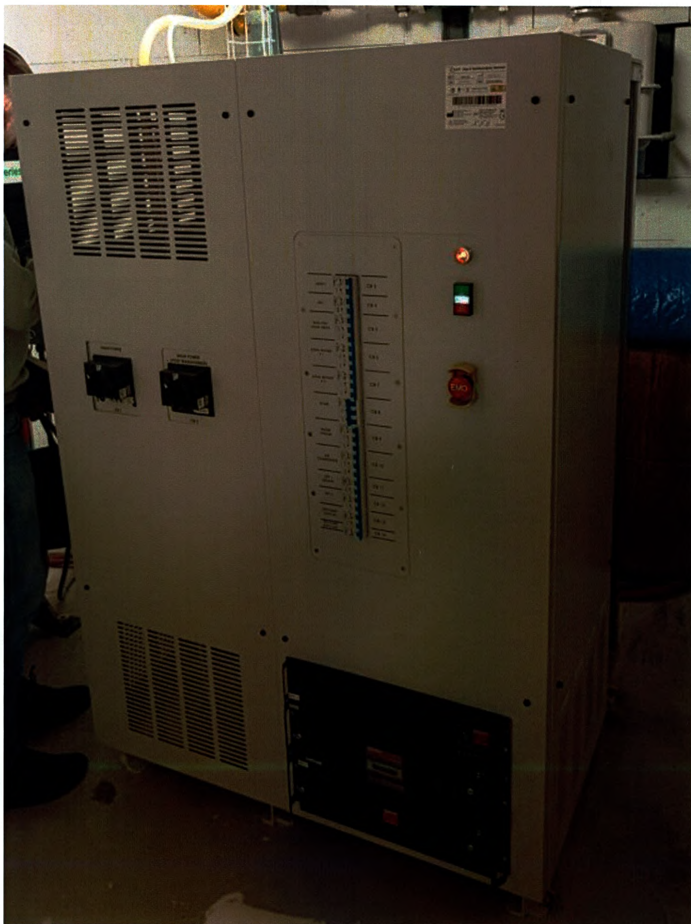
Силовой электрораспределительный шкаф
