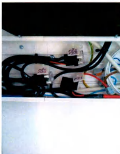
Плавкие предохранители в кабель-канале с маркировкой.
