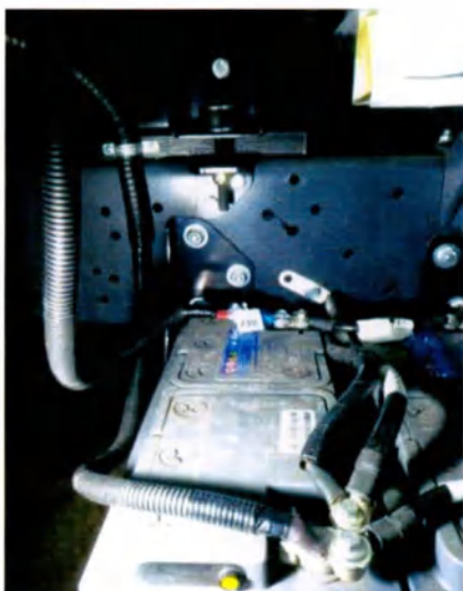
Плавкий предохранитель на плюсовой клемме аккумуляторной батареи с маркировкой.
