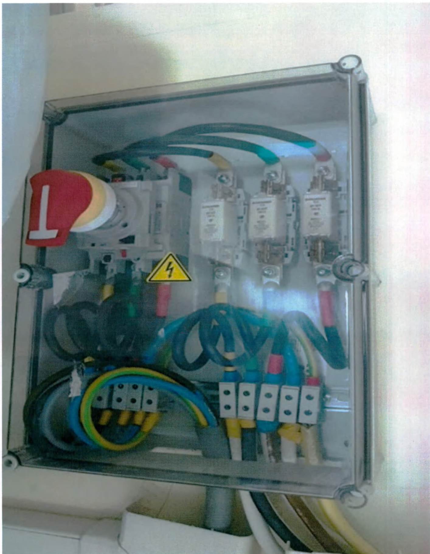
12. Рубильник включения электропитания - 1 шт.
