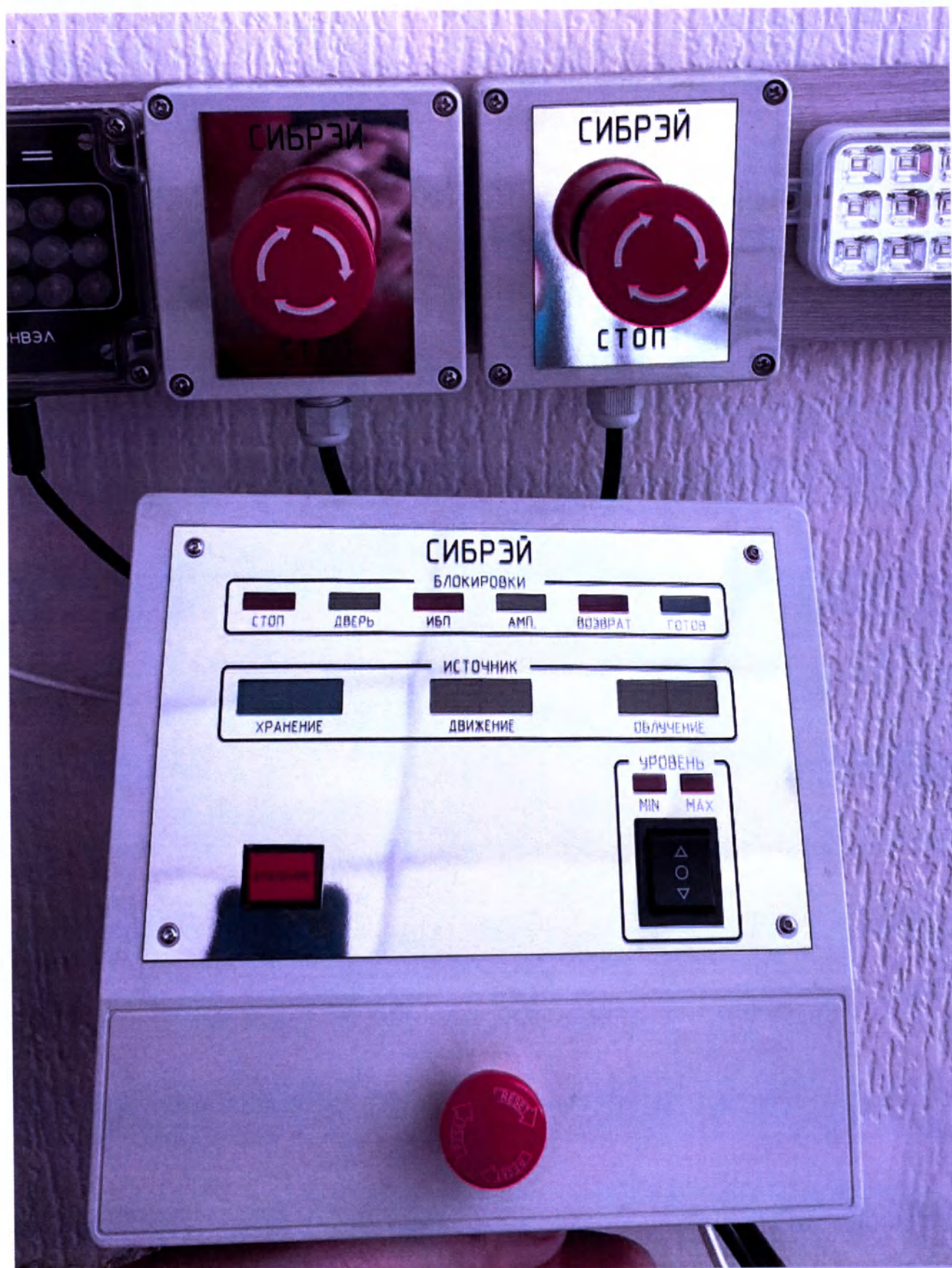
Пост аварийный (2 шт.), пульт выносной
