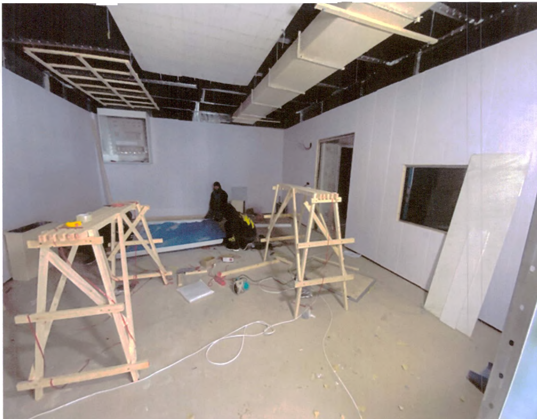
Радиозащитная комната в составе: клетка Фарадея, стеновые облицовочные панели и потолочные плитки, напольные покрытия, светильники, розетки, радиозащитное окно, радиозащитная дверь
