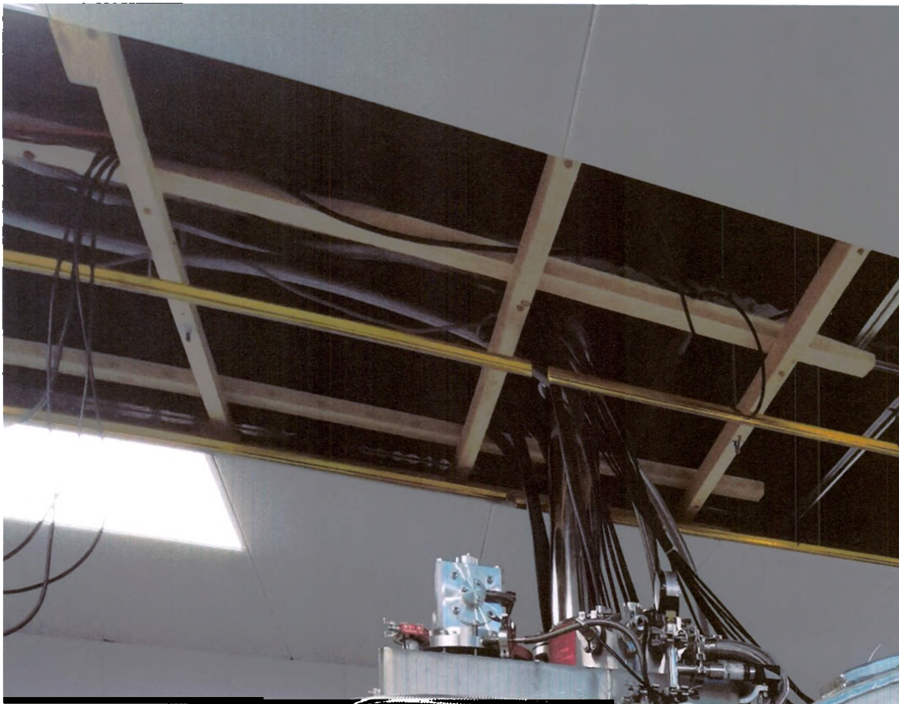
Силовые и соединительные кабели
