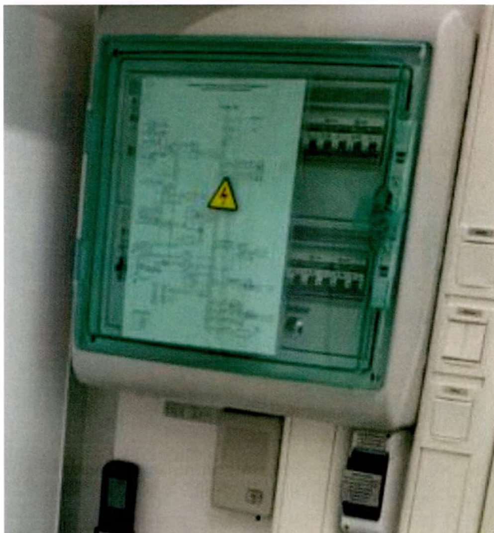
Система электропитания постоянного и переменного тока,
