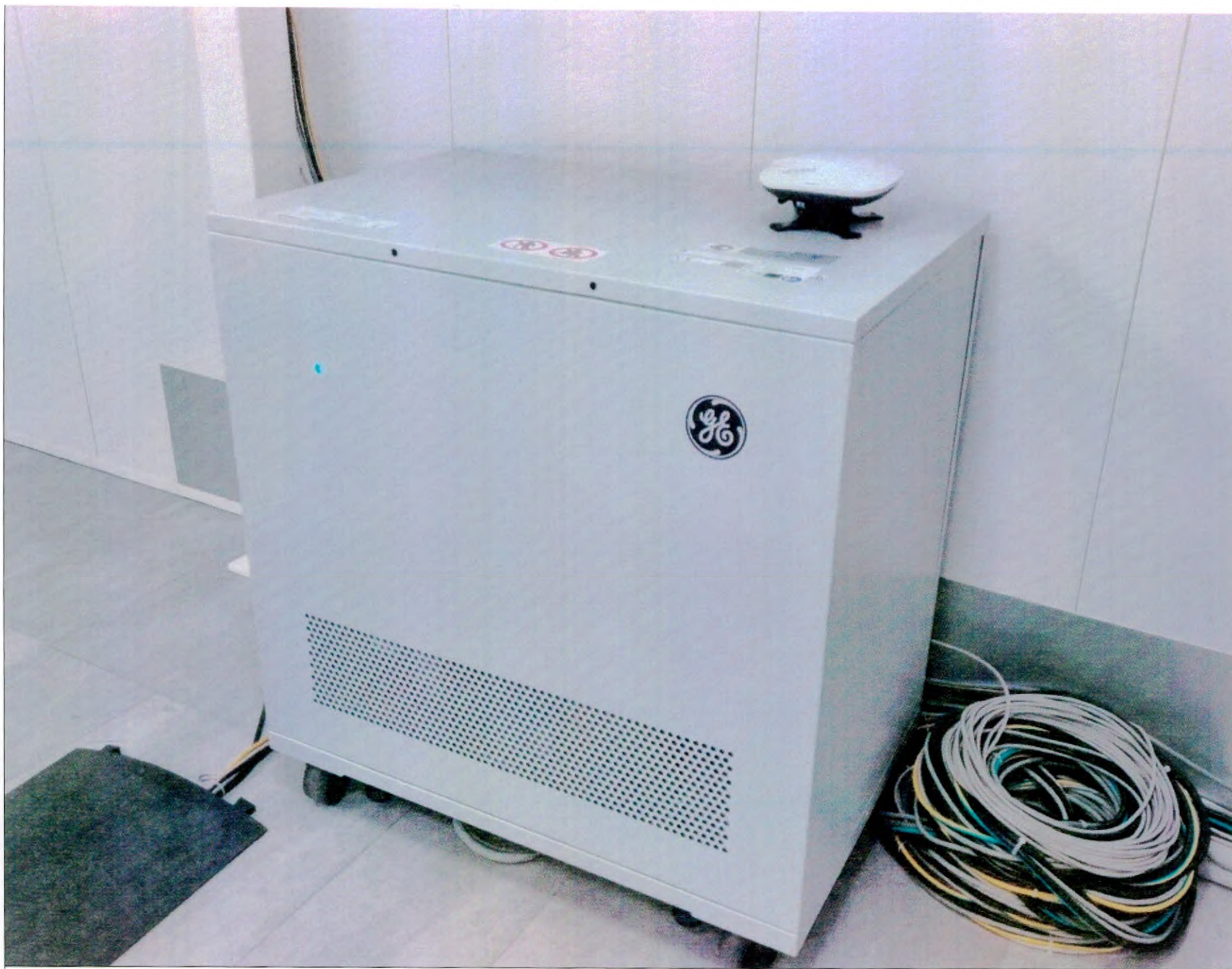
Рис. 19. Системный шкаф GCC (1 шт.)
