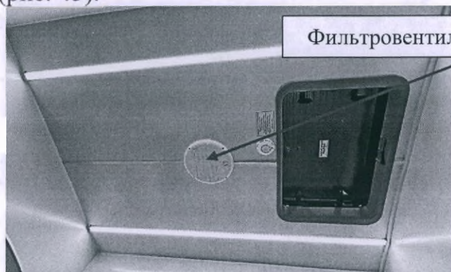
Рис. 44 - Расположение фильтровентиляционного устройства в процедурном кабинете (маммография)
