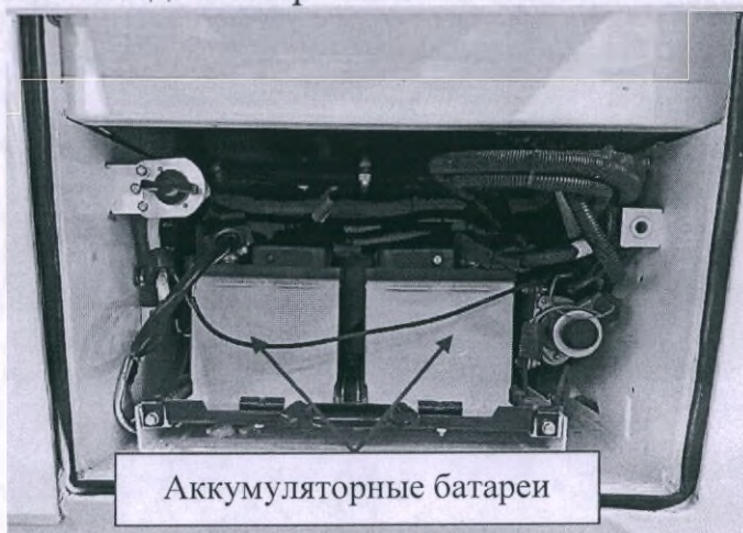
Рис. 25 – Аккумуляторные батареи комплекса
