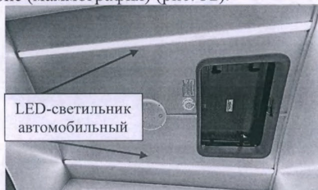
Рис. 31 - Плафоны освещения процедурного кабинета (маммография)
