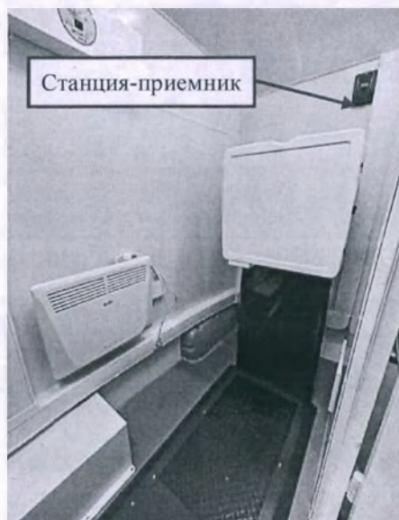
Рис. 74 - Переговорное устройство в процедурном кабинете (флюорография)
