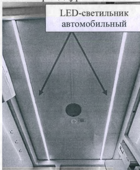
Рис. 22 - Плафоны освещения процедурного кабинета
