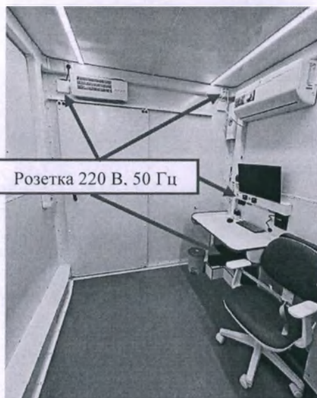
Рис. 14 - Розетки 220 В, 50 Гц в процедурном кабинете
