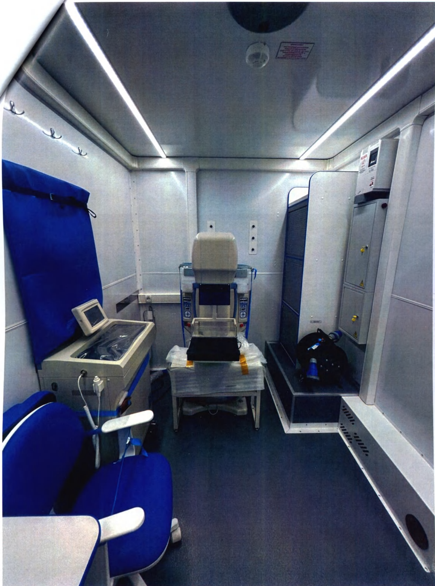
Рисунок 13 – Процедурный кабинет (шкаф, стабилизатор напряжения, щиток электрический, блок предохранителей, вольтметр)
