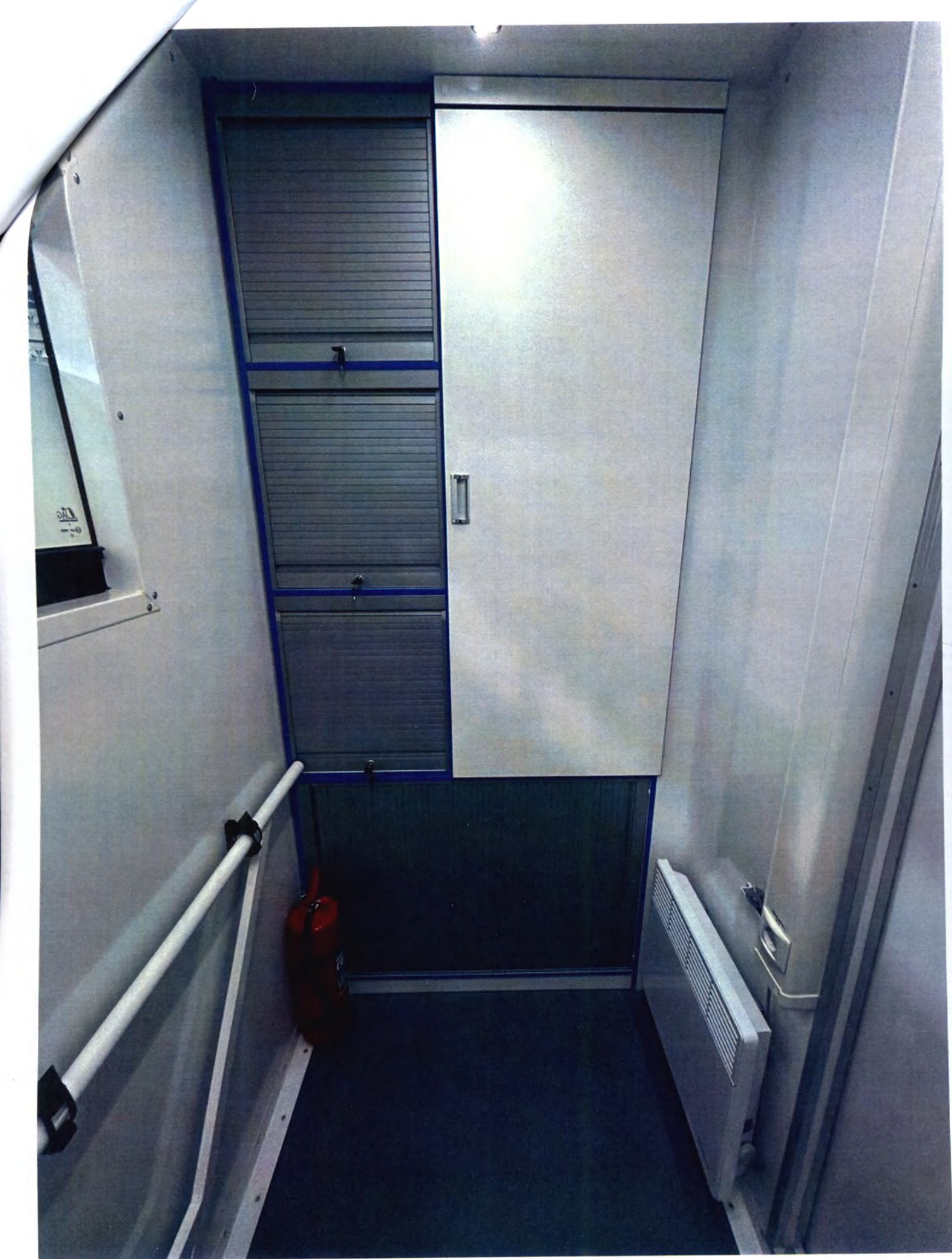
Рисунок 4 – Тамбур (шкаф, конвектор, огнетушитель ОП-5).
