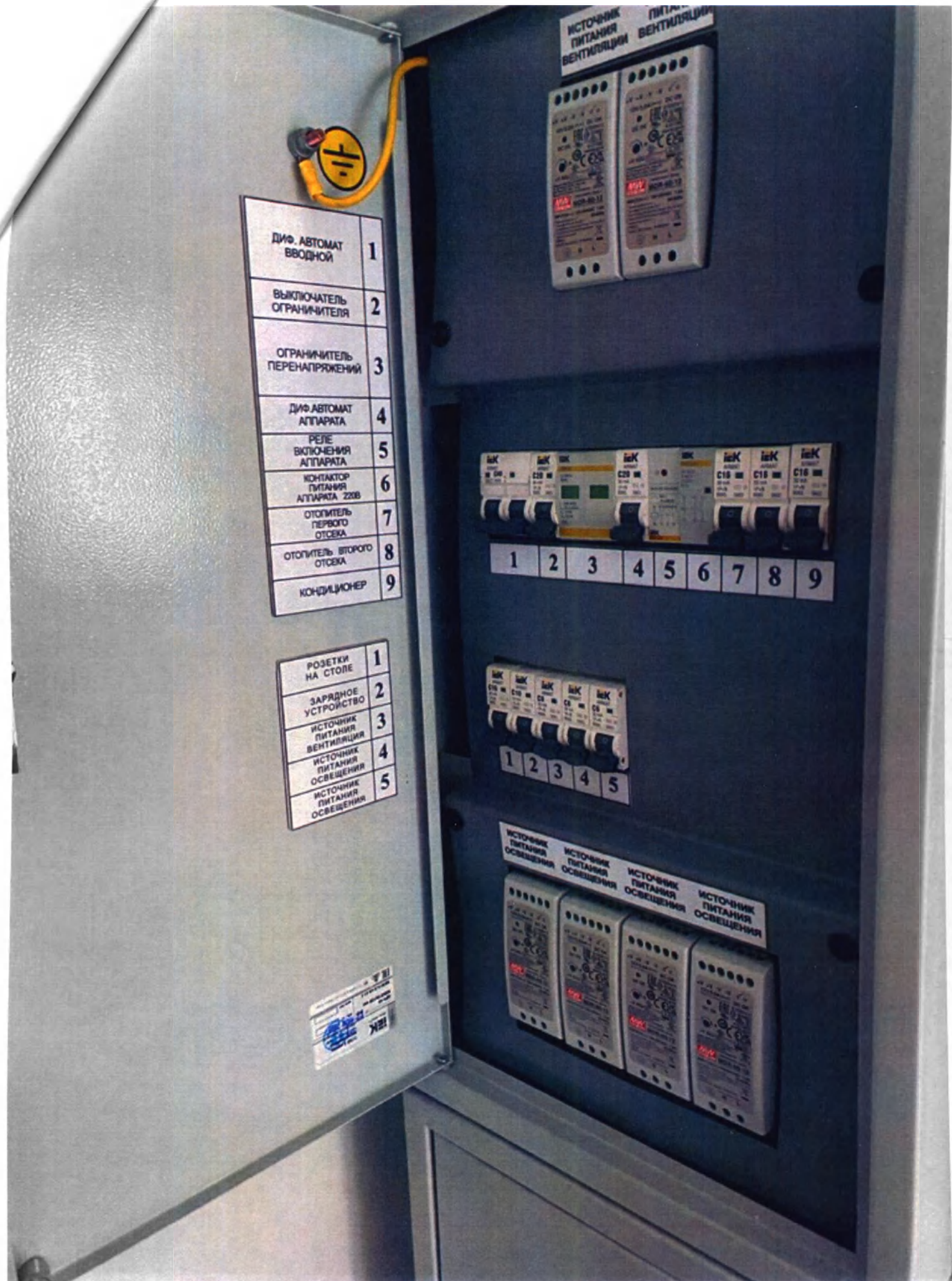
Рисунок 14 – Процедура кабинет (щиток электрический)
