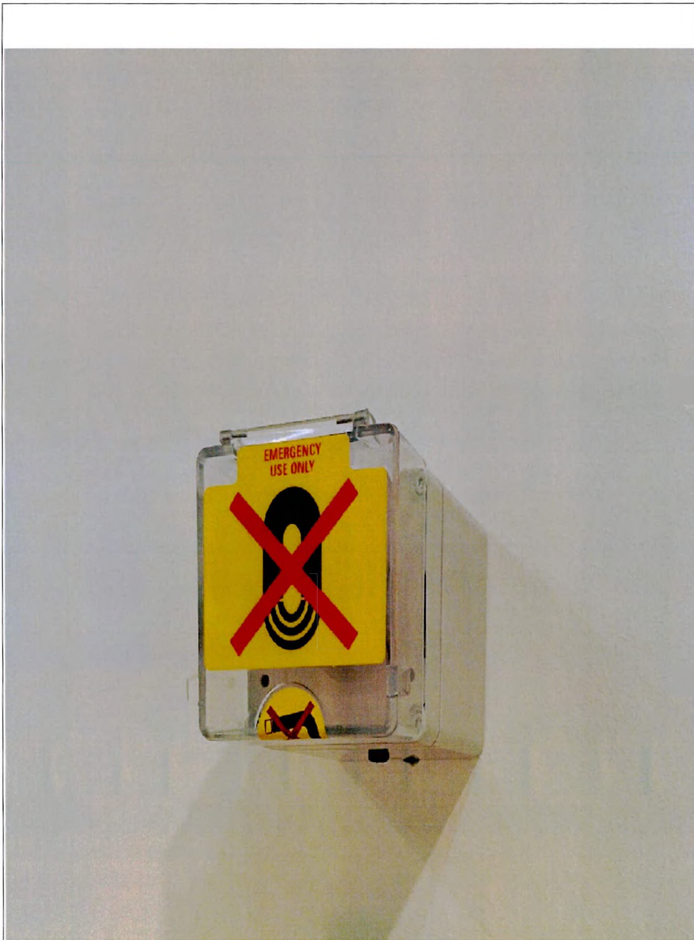
9. Аварийные выключатели, в составе: - Остановка магнита (Magnet Stop);
