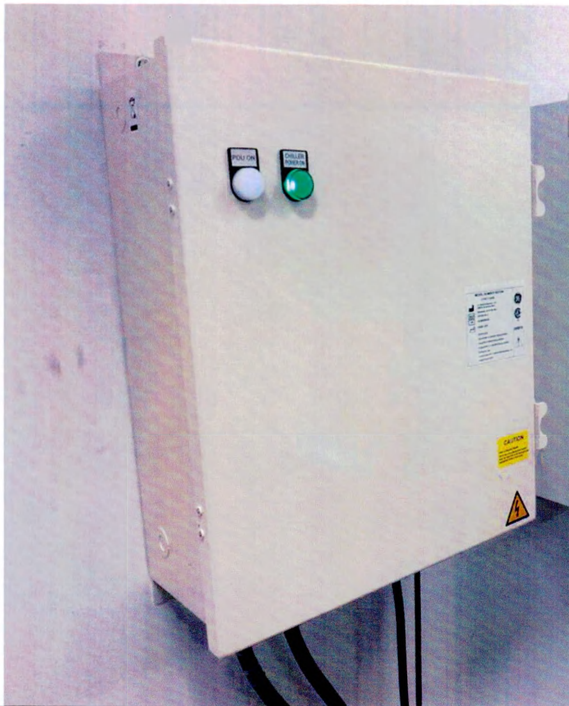
Рис. 19. Электрораспределительная панель (не более 10 шт.).
