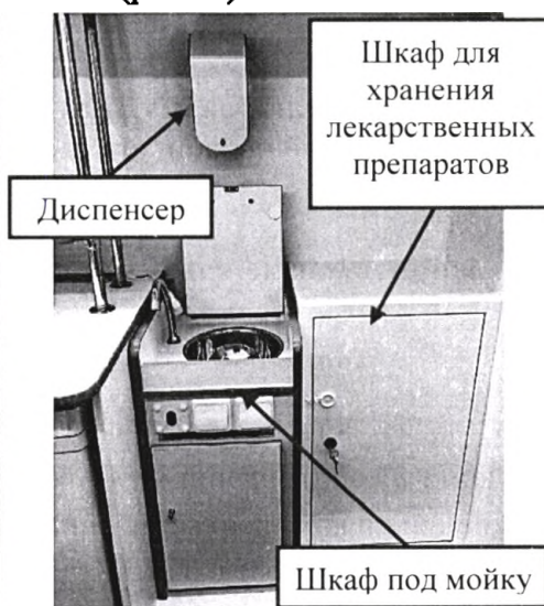
Рис.69 – Мебель и дополнительное оборудование медицинского отсека №2 (левый борт)
