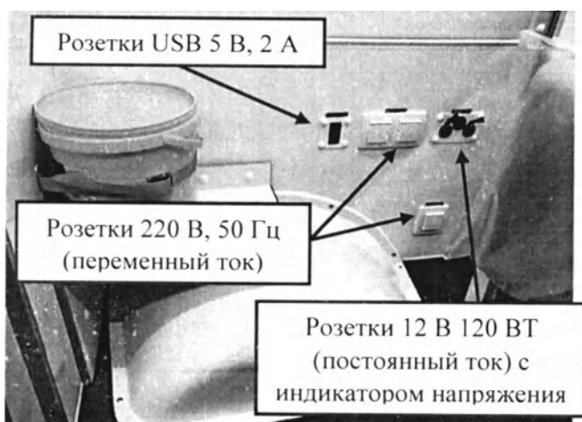
Рис.7 - Розетки по правому борту в медицинском отсеке №2
