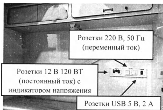
Рис.9 - Розетки по левому борту в медицинском отсеке №1
