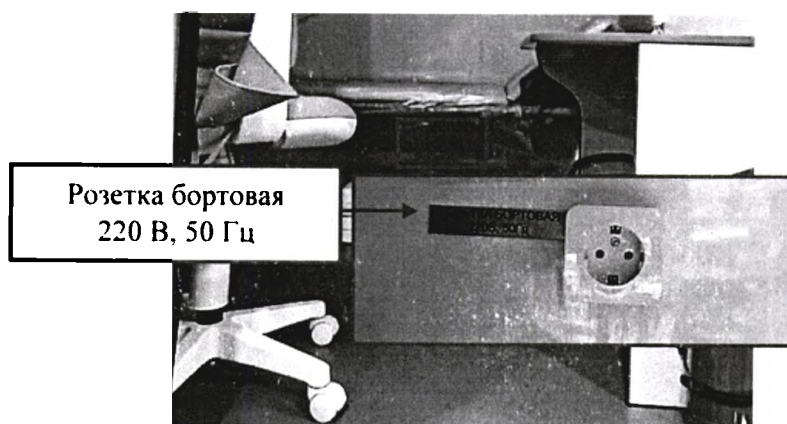
Рис.18 - Розетка бортовая по левому борту в медицинском отсеке №1
