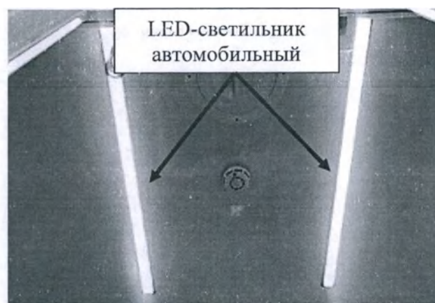
Рис. 16 - Плафоны освещения процедурного кабинета
