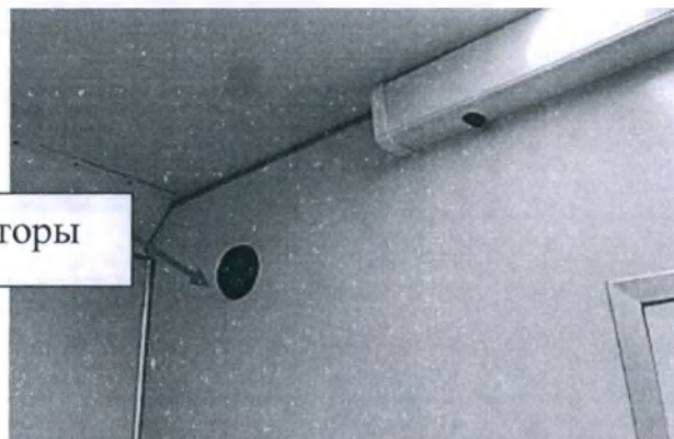
Рис. 44 - Дефлектор процедурного кабинета
