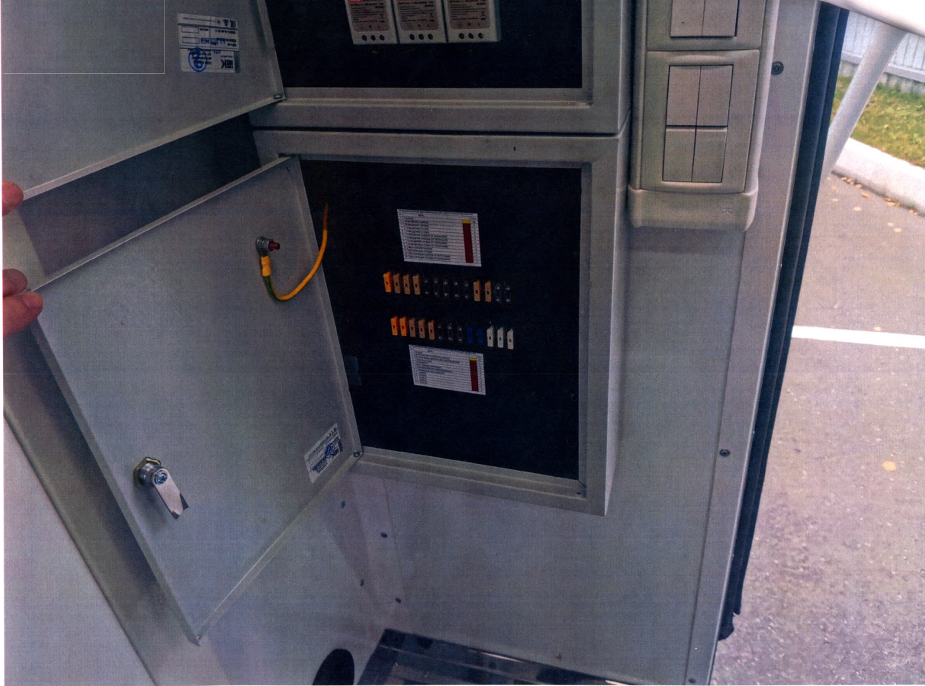
Рисунок 13 –Щиток электрический нижний в рабочем отсеке.
