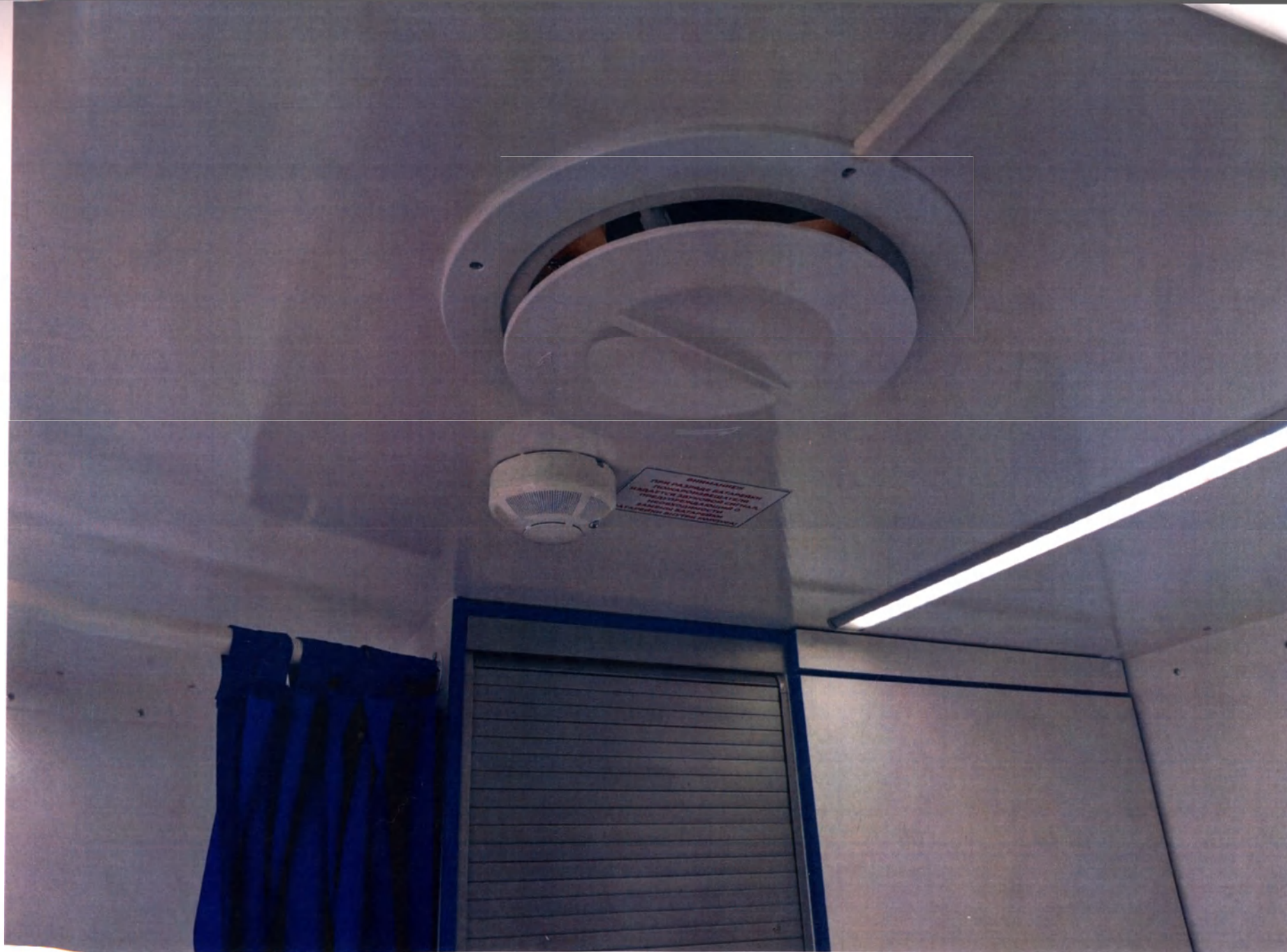
Рисунок 20 –Фильтровентиляционное устройство, пожарный извещатель.
