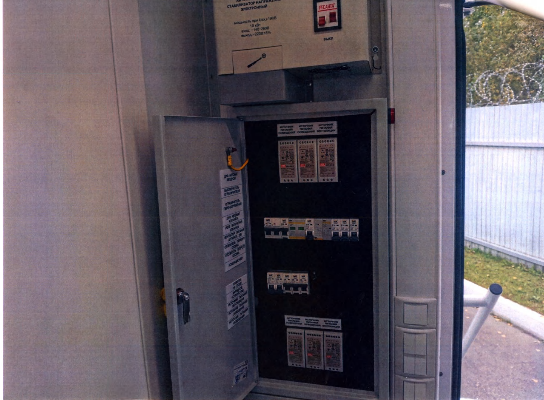
Рисунок 12 – Щиток электрический верхний в рабочем отсеке.
