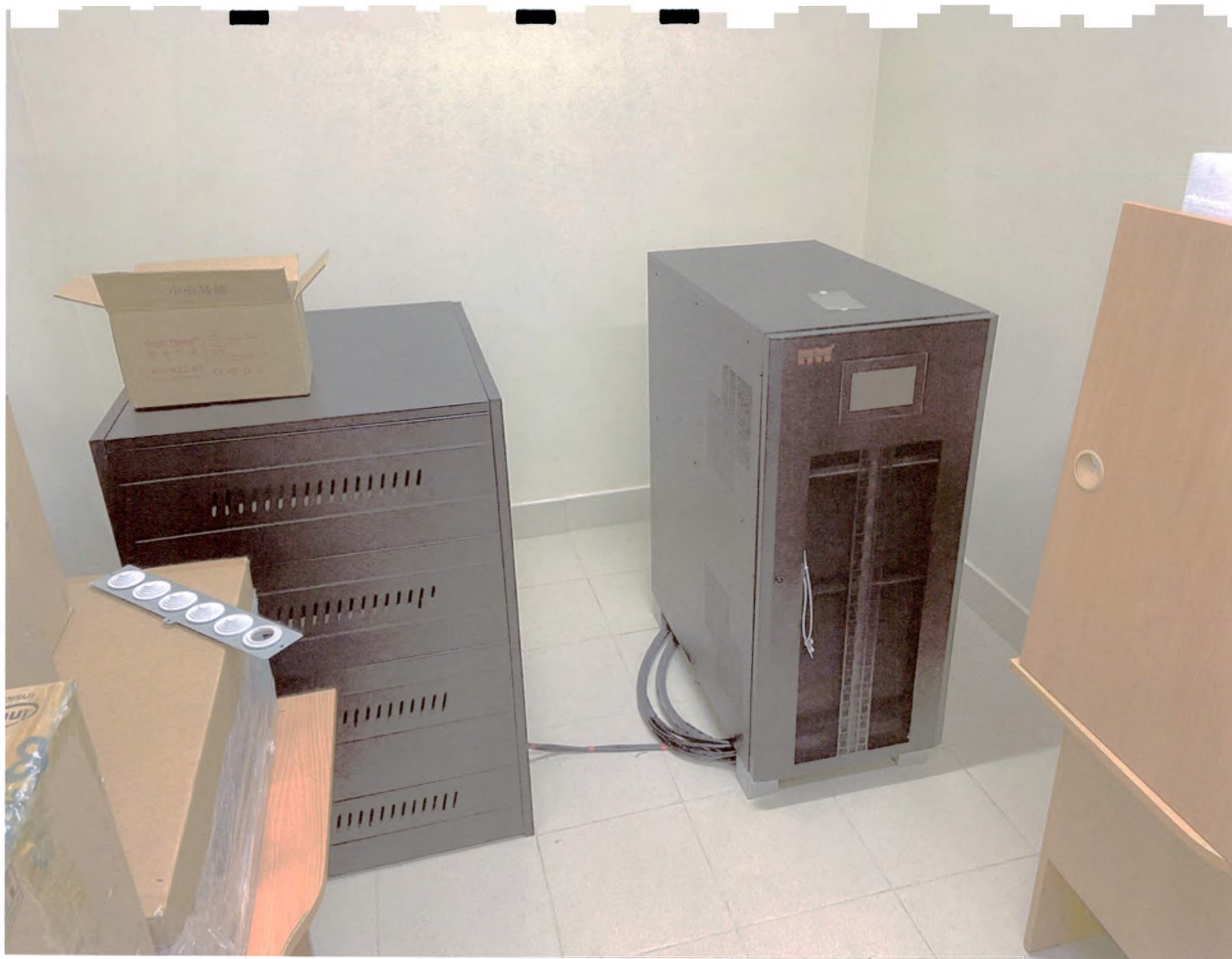
Источник бесперебойного питания на всю систему с комплектом аккумуляторов
