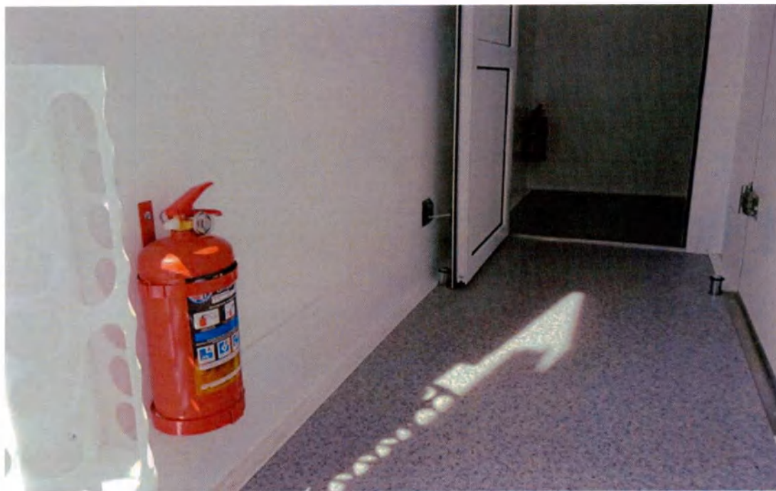
Рисунок 16. Огнетушители (внутри Комплекса).
