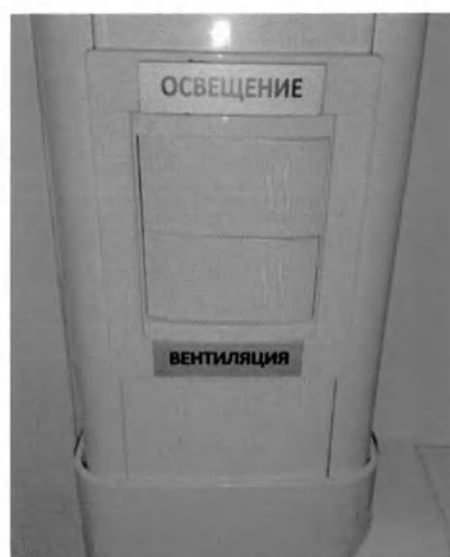
Рисунок 14. Включатель принудительной вытяжной вентиляции.
