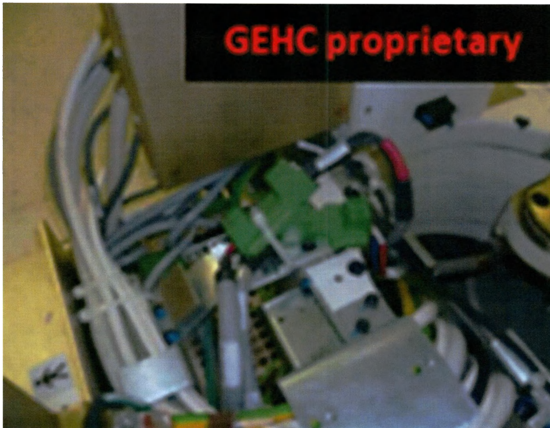
Рисунок 32. Кабели для монтажа системы
