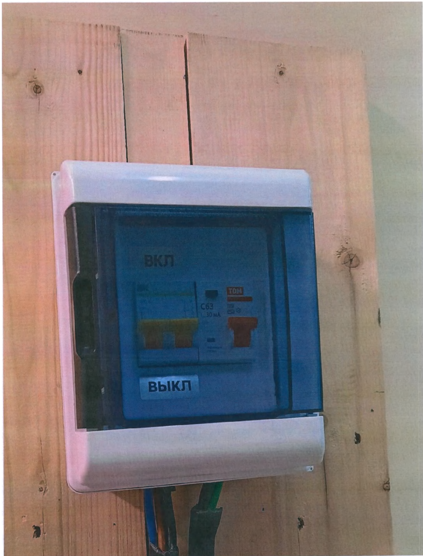
Рис 34. Щит электроснабжения ЛЖКМ.566112.003
