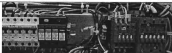
Подключение кабелей систем гентри
