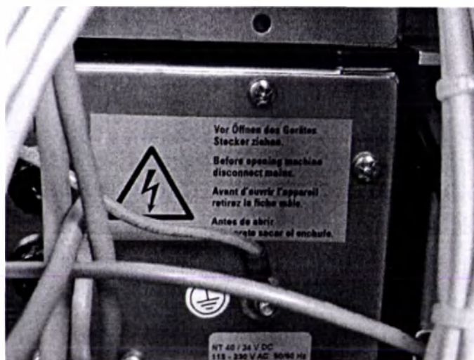
Фотография маркировки «Опасность поражения электрическим током!»
