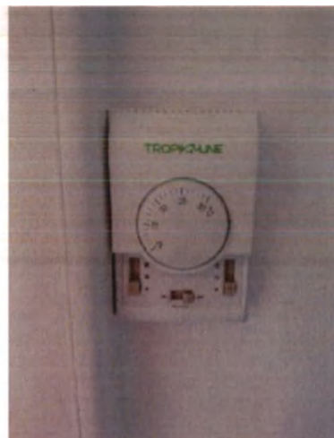
Рисунок 10.1. Пульт управления тепловой завесой.
