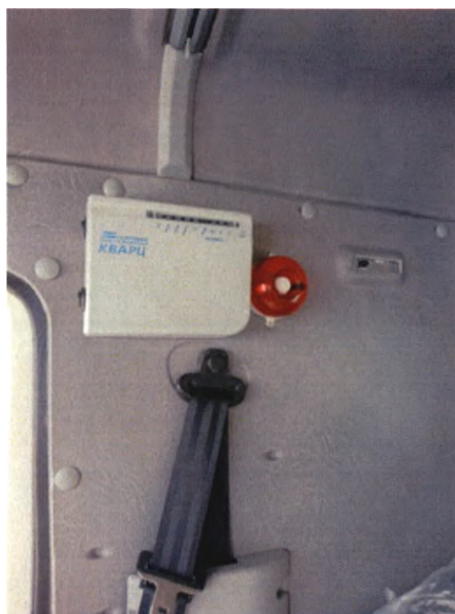
Рисунок 14. Прибор приёмно-контрольный охранно-пожарный.
