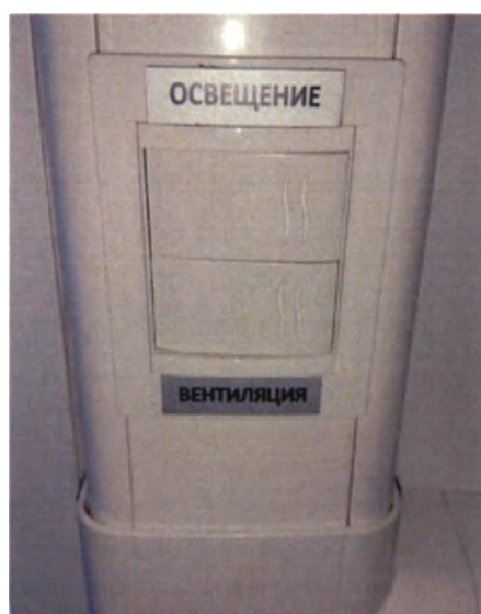
Рисунок 13. Включатель принудительной вытяжной вентиляции.
