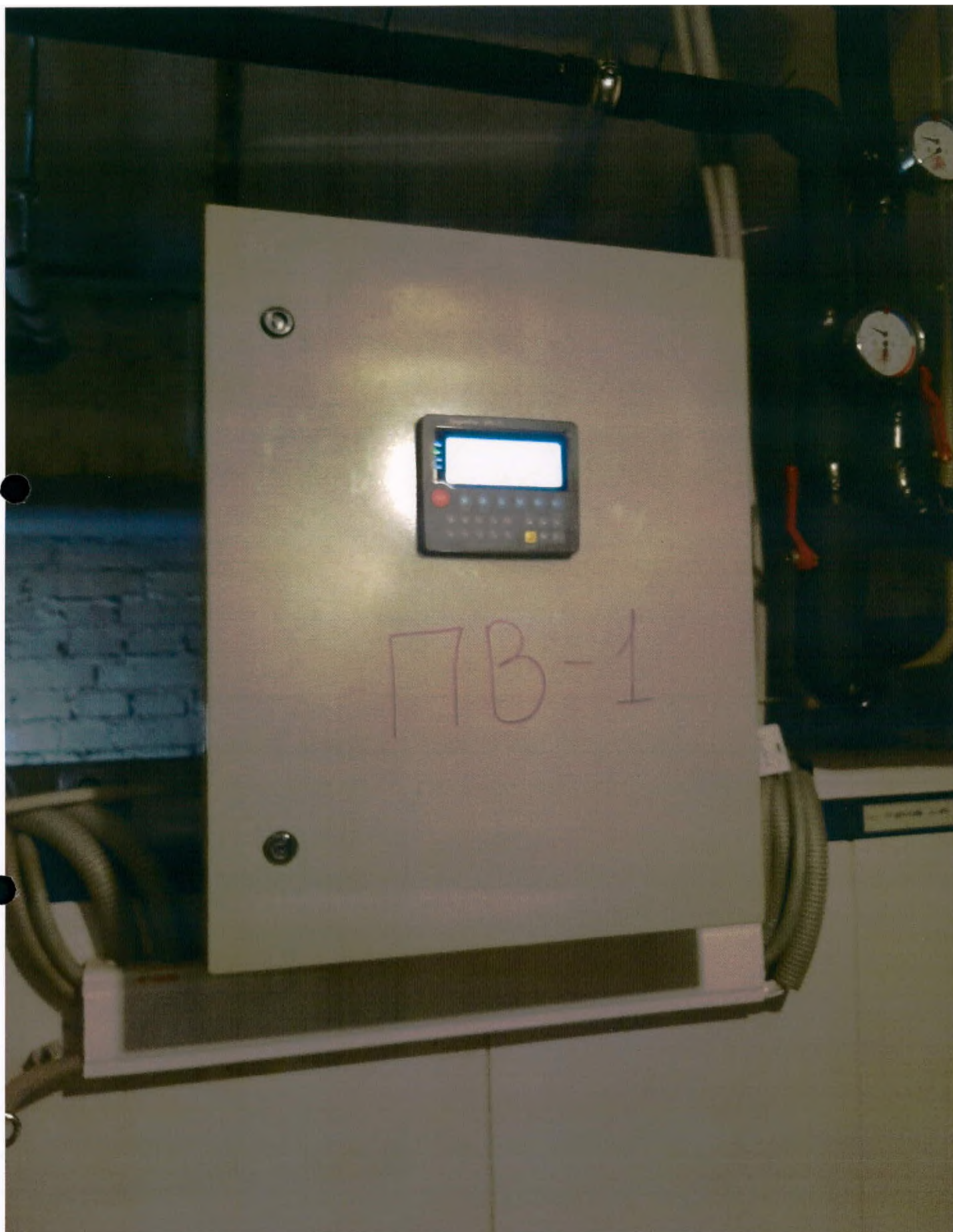
Смесительный узел DH-RR Danfoss Тепловой пункт US, производства «Danfoss A/S» (Дания)
