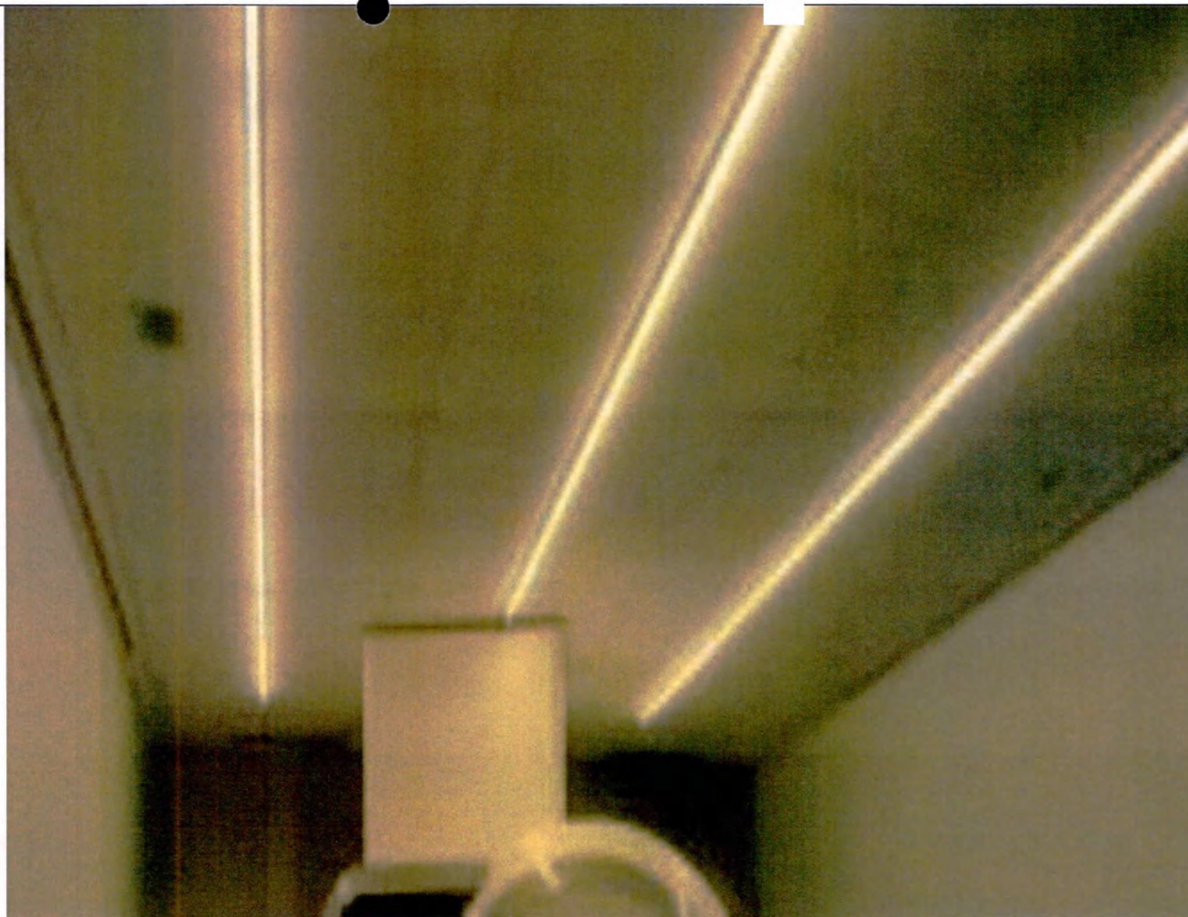
Облицовка радиочастотной кабины
