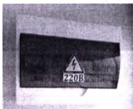
Рисунок 3. Навесной электрический распределительный щит.
