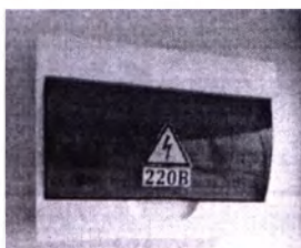
Рисунок 3. Навесной электрический распределительный щит.
