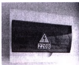
Рисунок 3. Навесной электрический распределительный щит.
