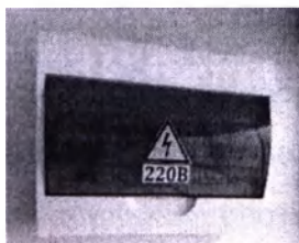
Рисунок 3. Навесной электрический распределительный щит.
