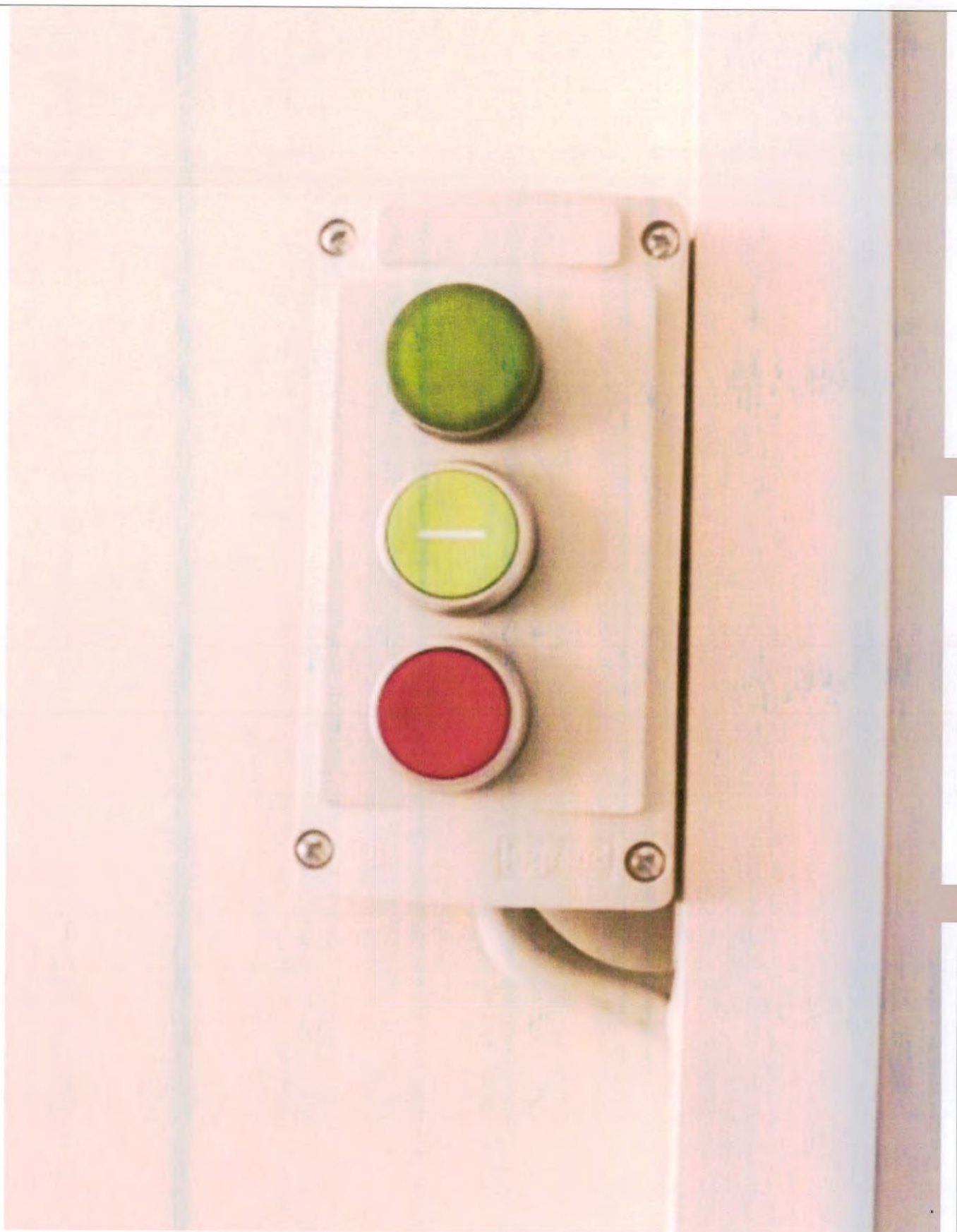
43. Рубильник включения электропитания.
