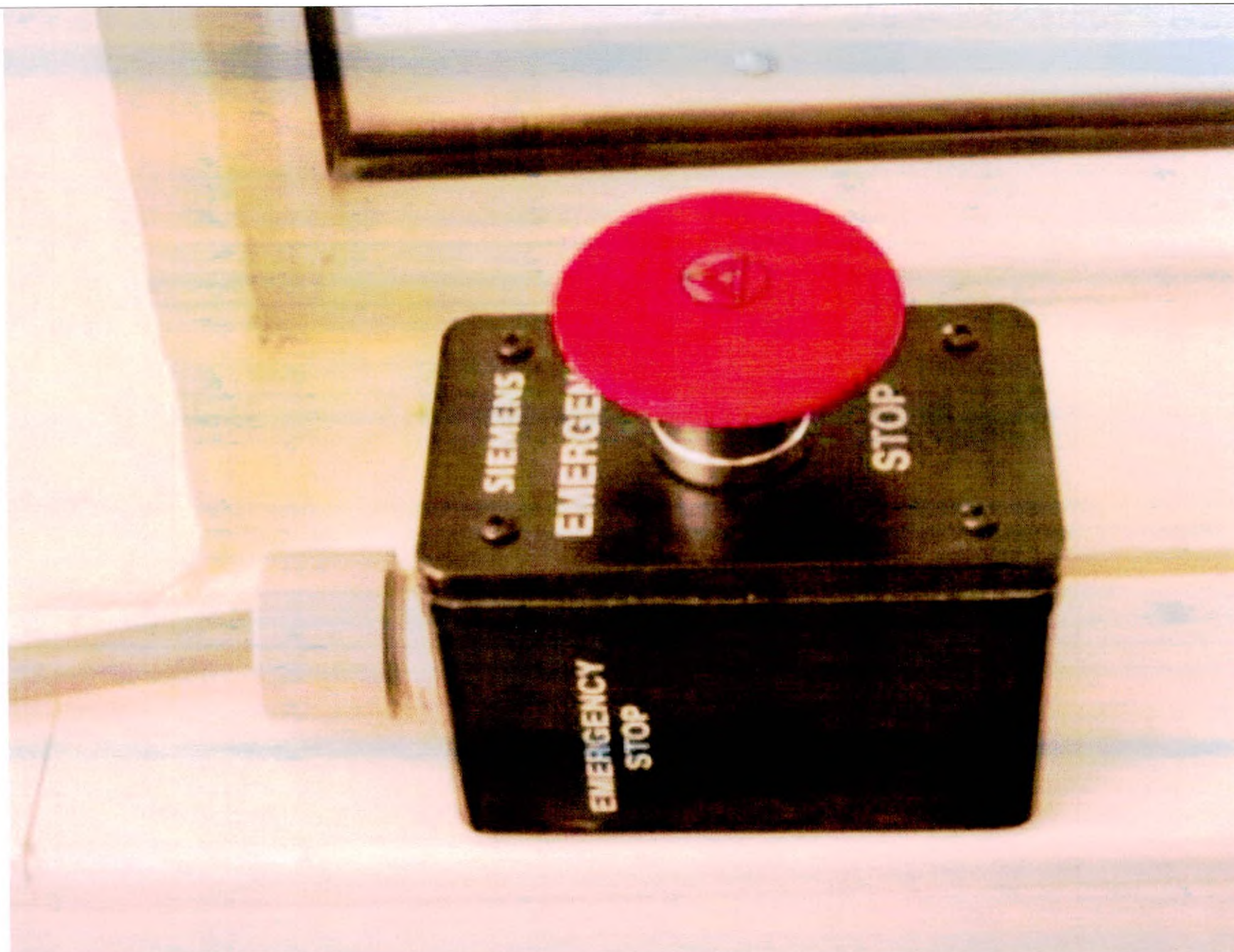
42. Рубильник аварийного выключения.
