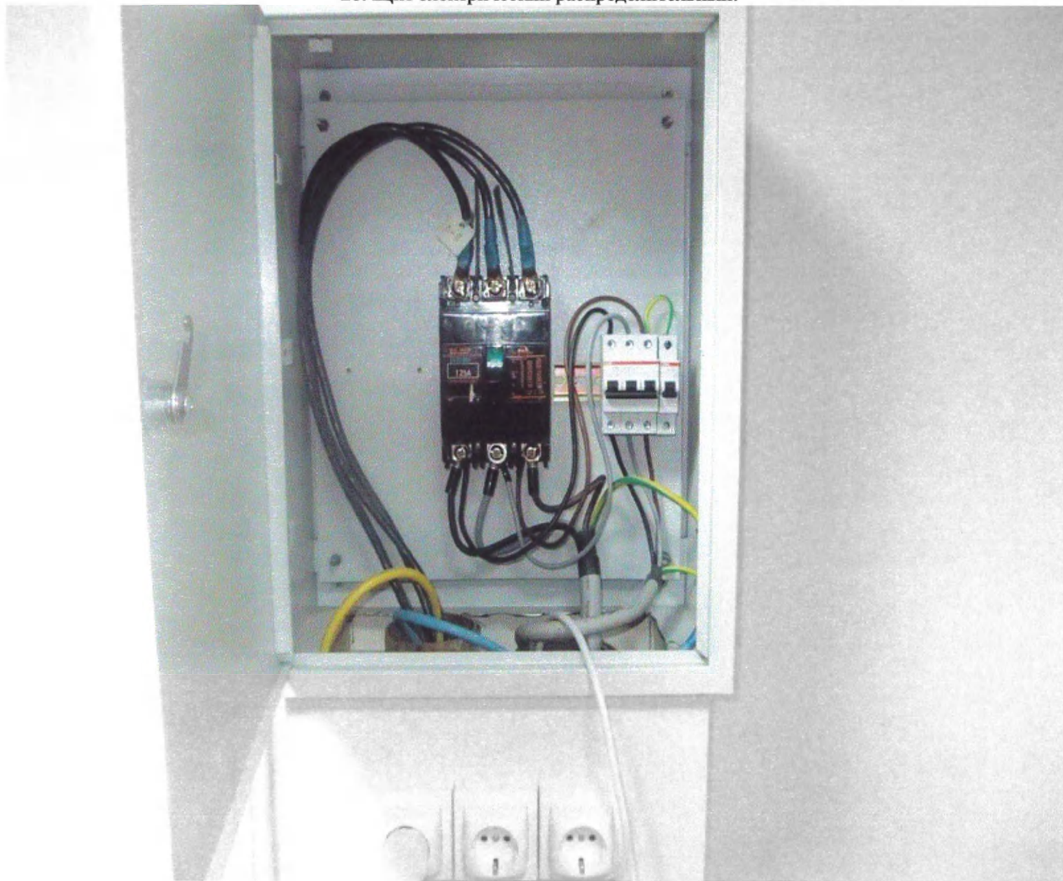
20. Щит электрический распределительный:
