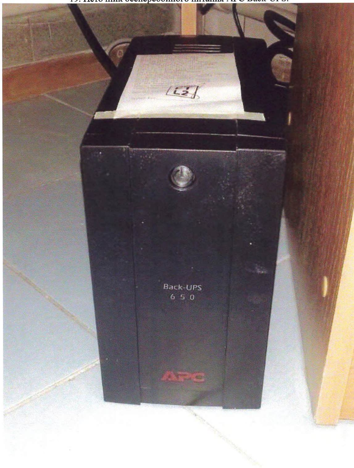
19. Источник бесперебойного питания APC Back-UPS:
