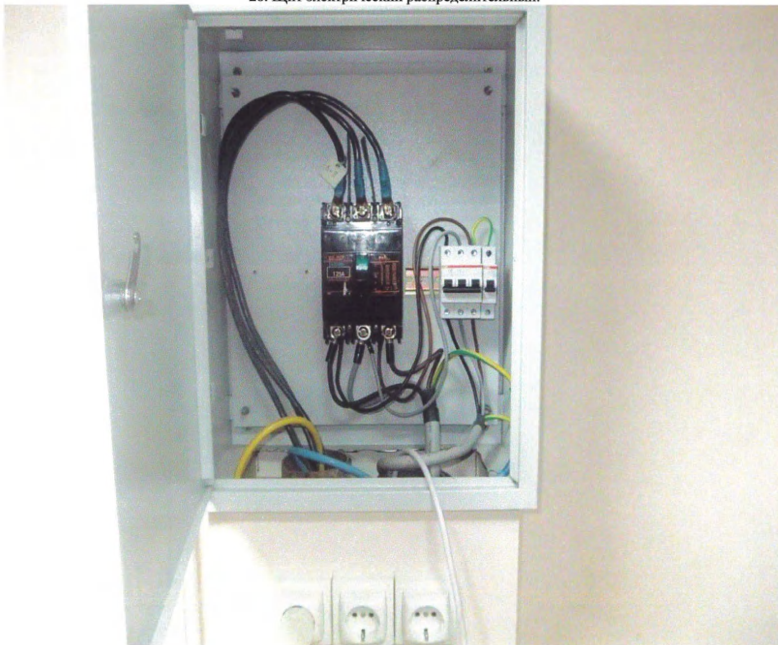
20. Щит электрический распределительный:
