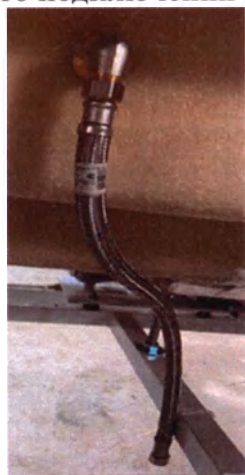
Рис. 9. Отвод охлаждающей воды
