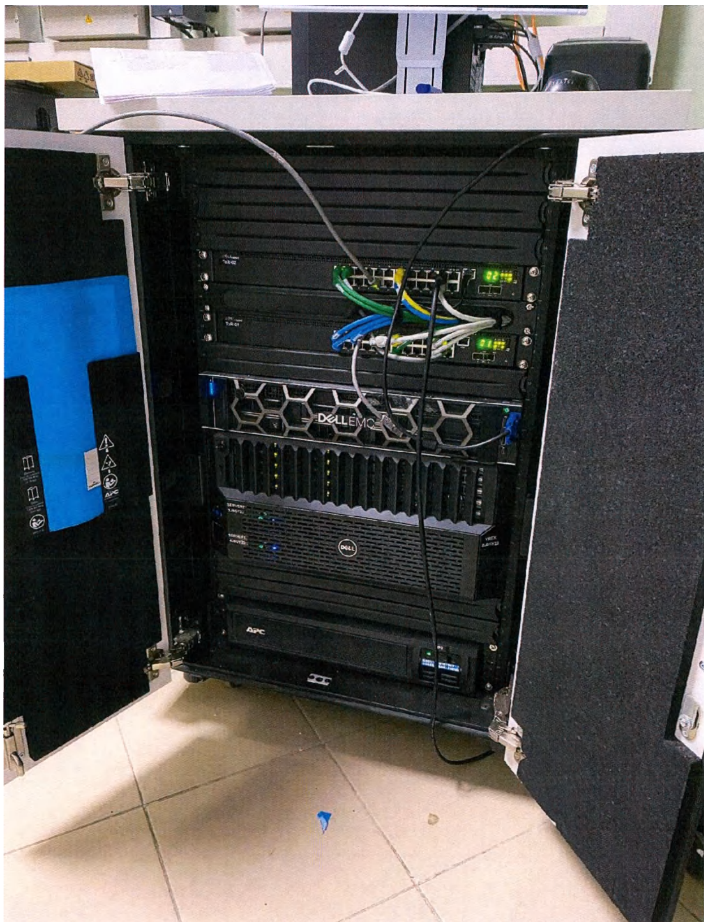
Блок управления системой
