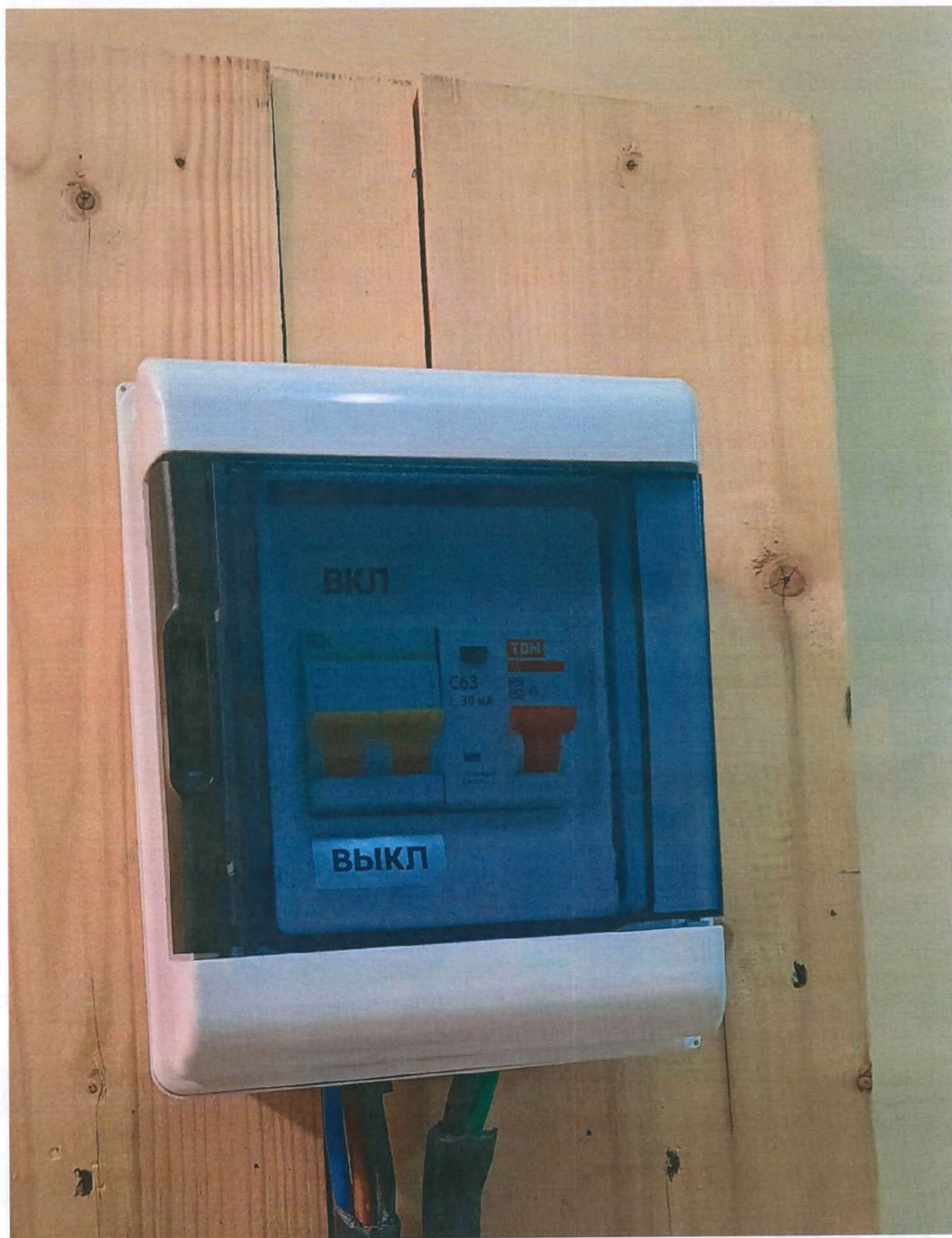
Рис 28. Щит электроснабжения ЛЖКМ.566112.001, производства ООО «С.П.ГЕЛПИК», Россия;
