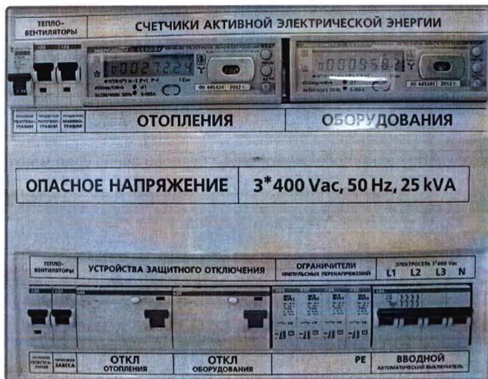
Рисунок 3.22 – Передняя панель щита 1 «Вводной»
